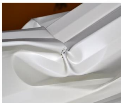
Obrázek 22: Detail plastické deformace vlny trapézového profilu [21]
