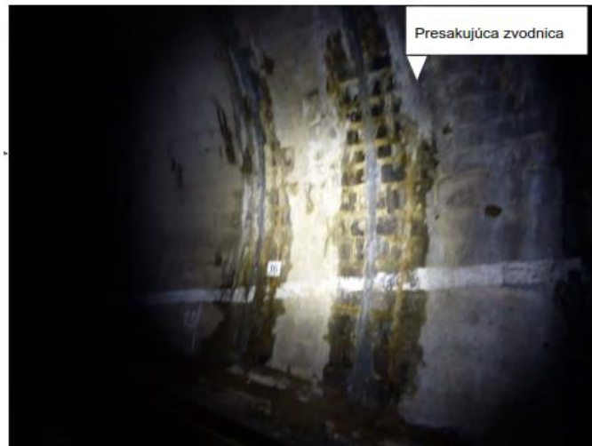
Obr. 3 Harrachovský tunel po rekonštrukcii – presakujúca voda v oblasti zvodnice [1]
