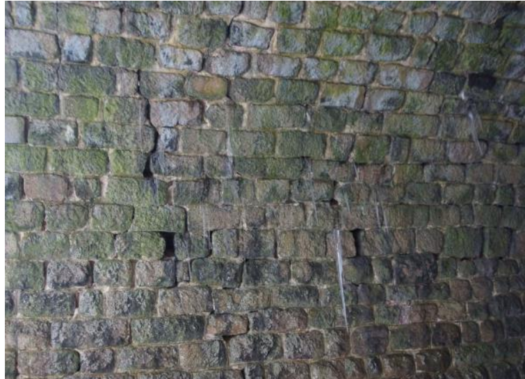
Obr. 27 Súčasný stav Dolnolučanského tunela –trhliny vo výmurovko od horninového tlaku [20]
