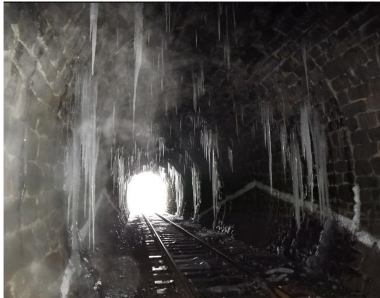
Obr. 26 Súčasný stav Dolnolučanského tunela – zaľadovanie tunela [20]
