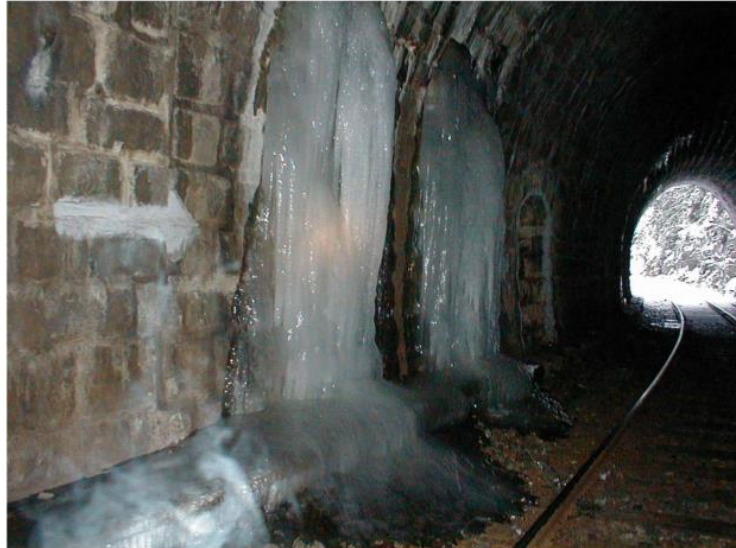
Obr. 1 Priesak vody ostením - zaľadovanie tunela [1]
