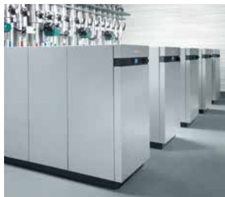
Technická místnost v Manise (Turecko) s pěti tepelnými čerpadly Vitocal 300-G Pro pro klimatizování budovy.
