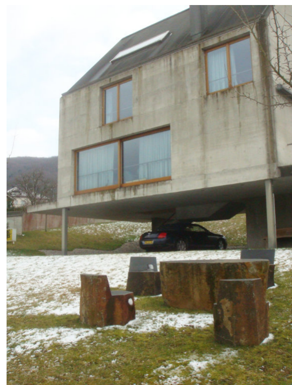
◁ Obr. 15 Rudin House, Leymen, propisující se trvalá proměna pohledových ploch vlivem absence okapnice [19]
