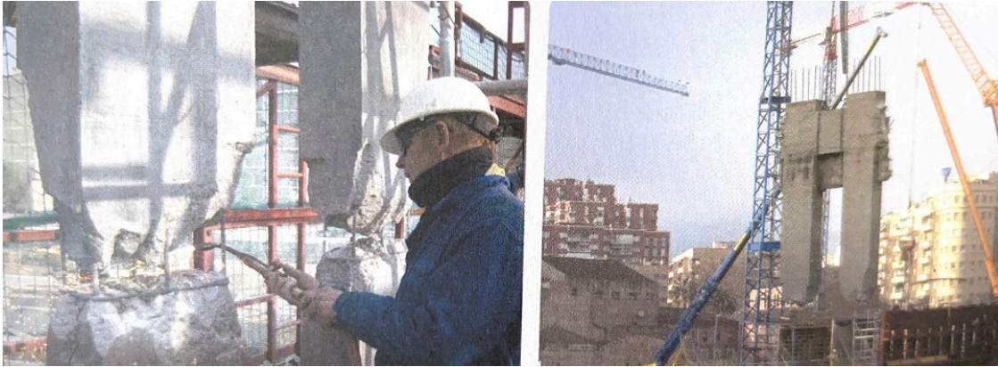
△ Obr. 51 Opravy a demolice. Přes veškerou snahu je téměř nemožné zcela eliminovat sporadický výskyt vad pohledového betonu [5]
