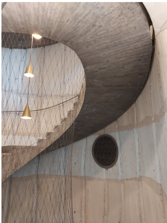
◁ Obr. 110 Interiéry Paláce Národní, DRN. ◁ Beton má v DRNU nosnou i pohledovou funkci, aplikace různého bednicího materiálu a experimentování s širokou škálou pigmentu k probarvení betonu vytváří unikátní interiér Realizace: 2018 ARCHITEKT: Stanislav Fiala
