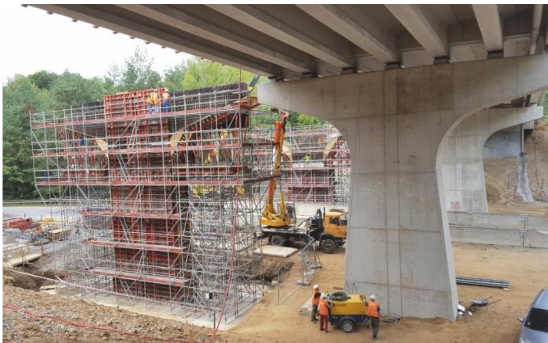
Obr. 27: Montáž bednění pilíře pravého mostu (vlevo) a dokončený pilíř levého mostu (vpravo) v rámci rekonstrukce mostu D1-035.
