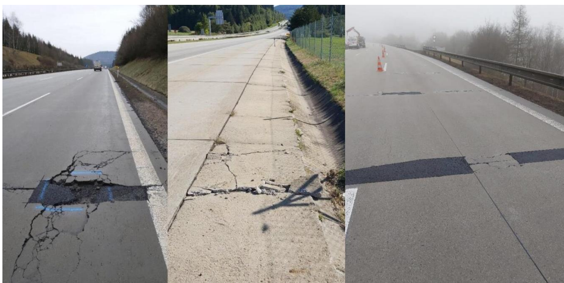
Obr. 7: Stav původního cementobetonového krytu vozovky dálnice D5, resp. jeho asfaltových výprav, po 25 letech provozu. Zdroj: ŘSD ČR [23]
