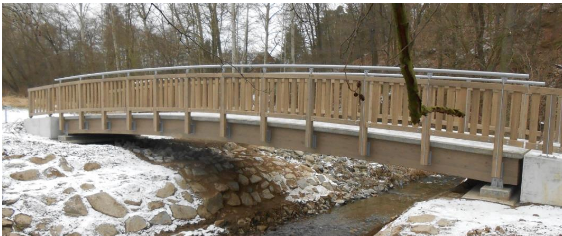
Obr. 43: Dřevobetonová lávka přes Benešovský potok rozpětí 13,6 m, první realizace v ČR, rok 2016 – konstrukci tvoří 7 obloukových nosníků z lepeného lamelového dřeva a mostovka z běžného betonu. [73]
