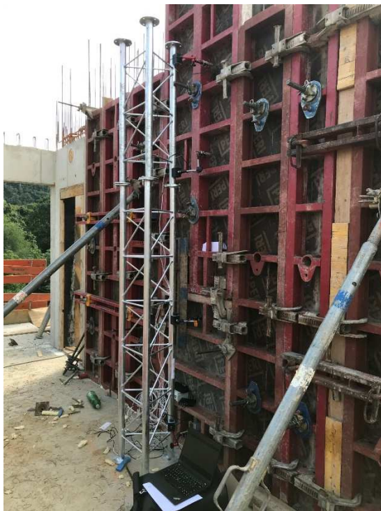
Obr. 4.31: Konstrukce pro osazení přístrojů pro měření tlaků a deformace
