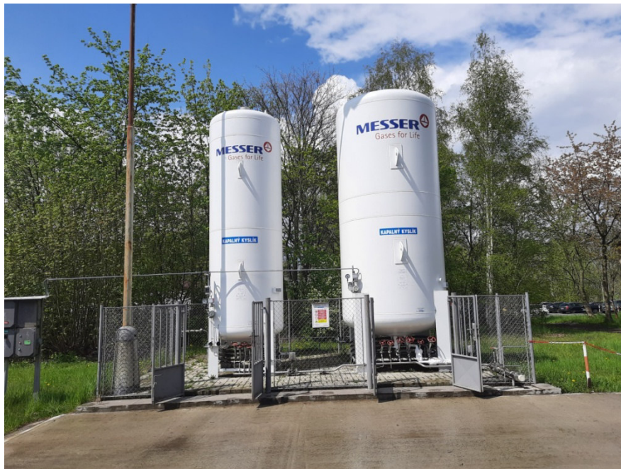
Obrázek 5- Zásobníky kapalného kyslíku v areálu I ONP (zdroj:vlastní)
