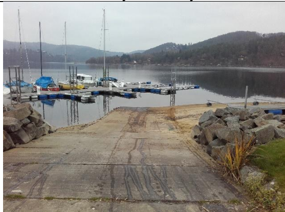
nizký stav vody
