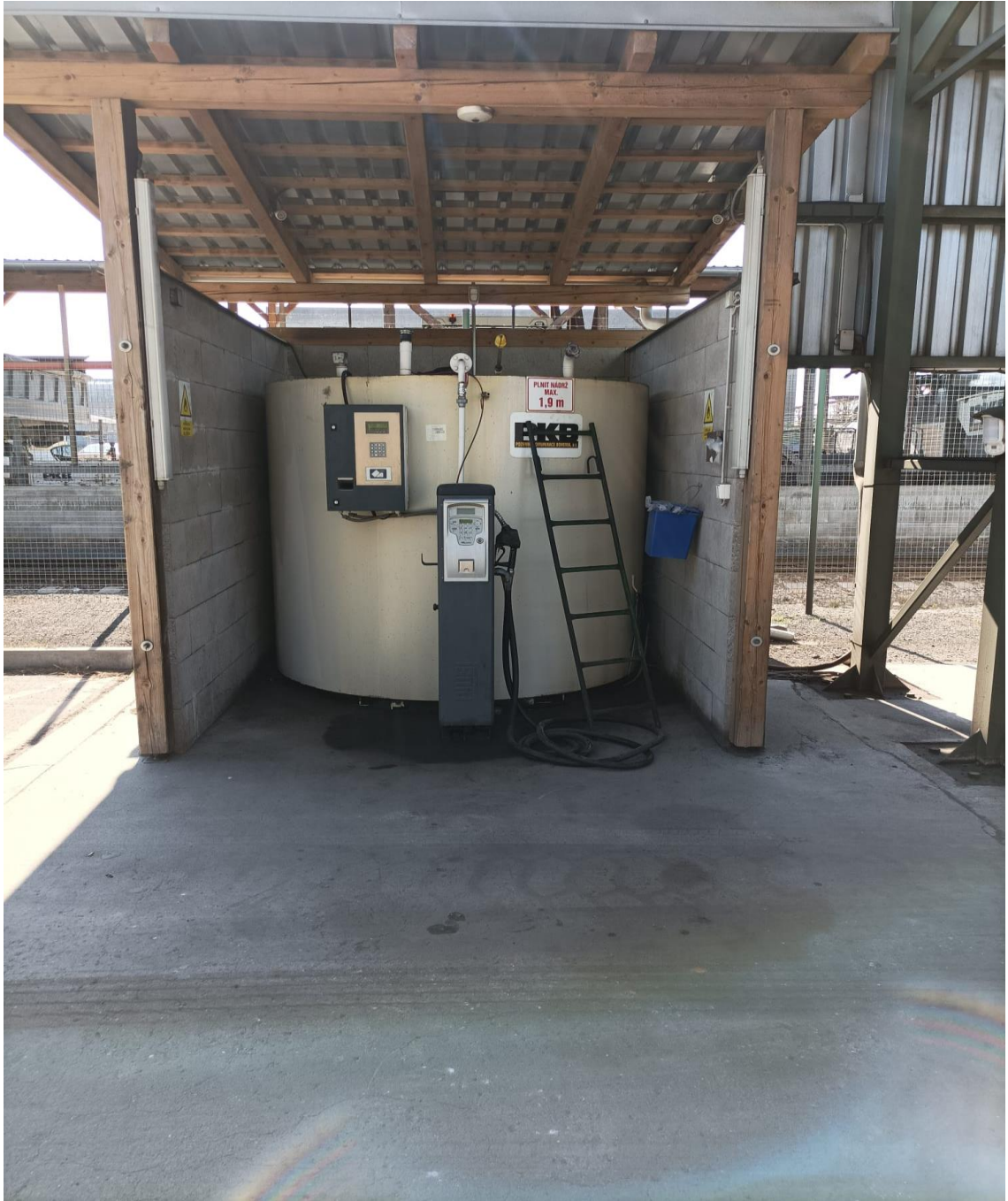
Příloha 7 Nádrž pro tankování nafty (zdroj vlastní)
