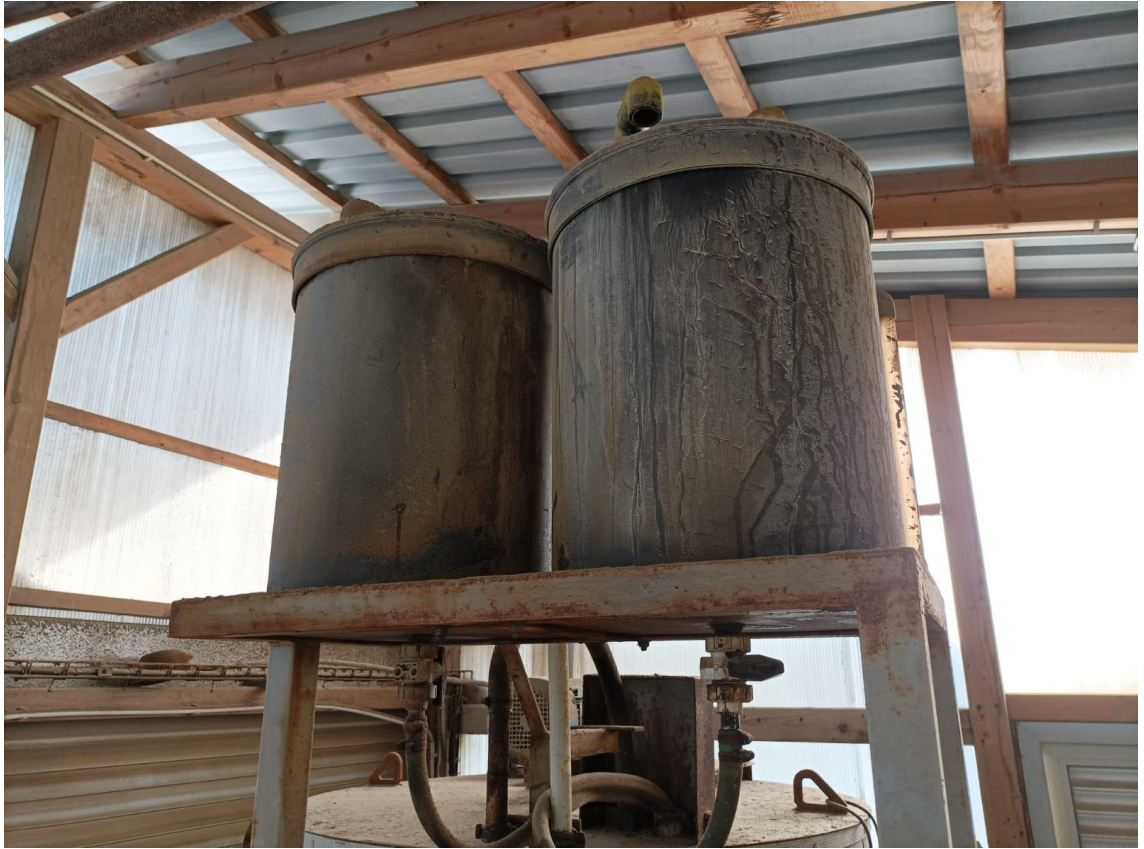
Příloha 5 Nádrž kyseliny chlorovodíkové v mísárně asfaltových emulzí
