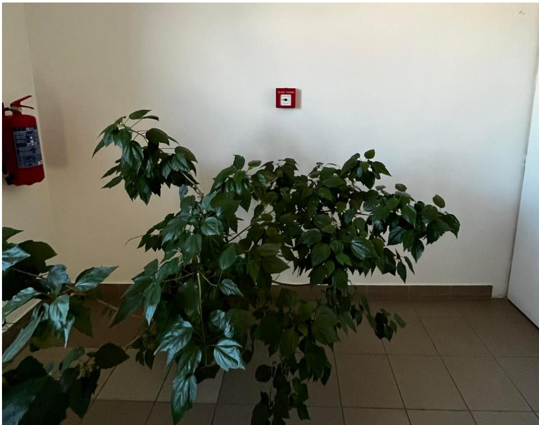
Obrázek 2: Překážka před tlačítkovým hlásičem. (Zdroj: vlastní zpracování)
