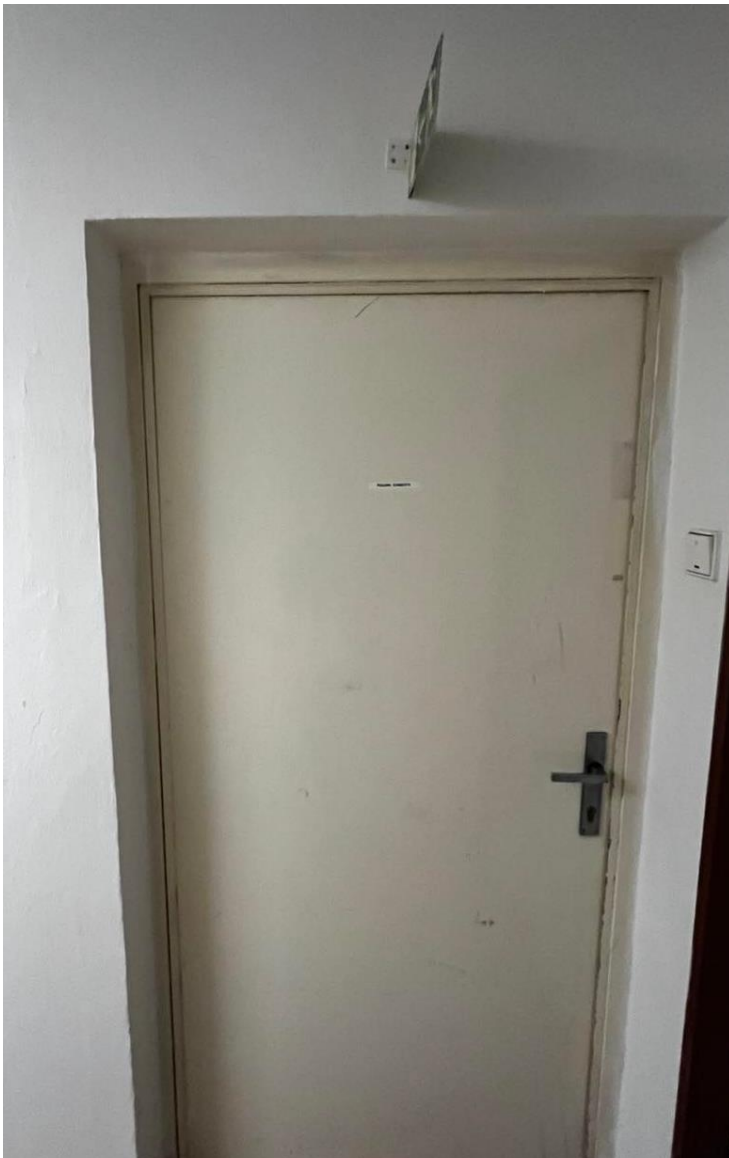
Obrázek 3: Nepřehledné označení únikového východu. (Zdroj: vlastní zpracování)
