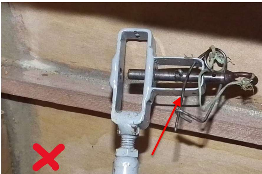
Obrázek 2: Nesprávné zajištění manuálního spoje [4]
