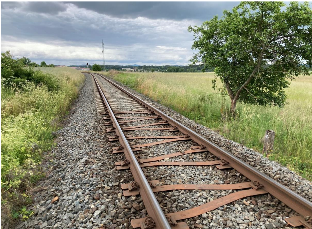
Obrázek 60: Ocelové pražce typu Y v úseku Tachov-Biletín – Lom u Tachova; autor
