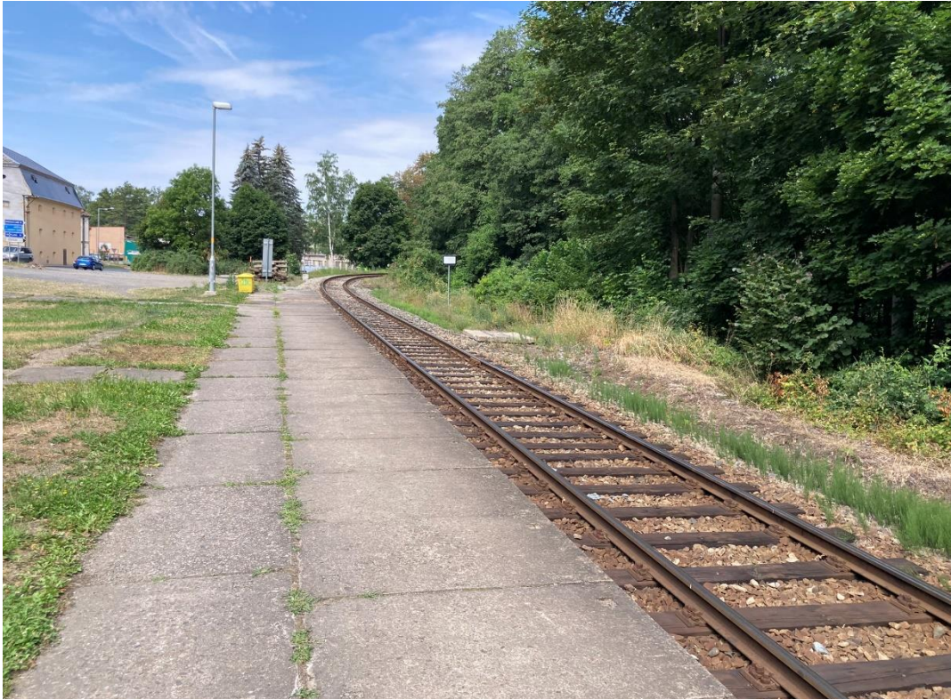
Obrázek 57: Aktuální stav nástupiště v zastávce Tachov zastávka; autor
