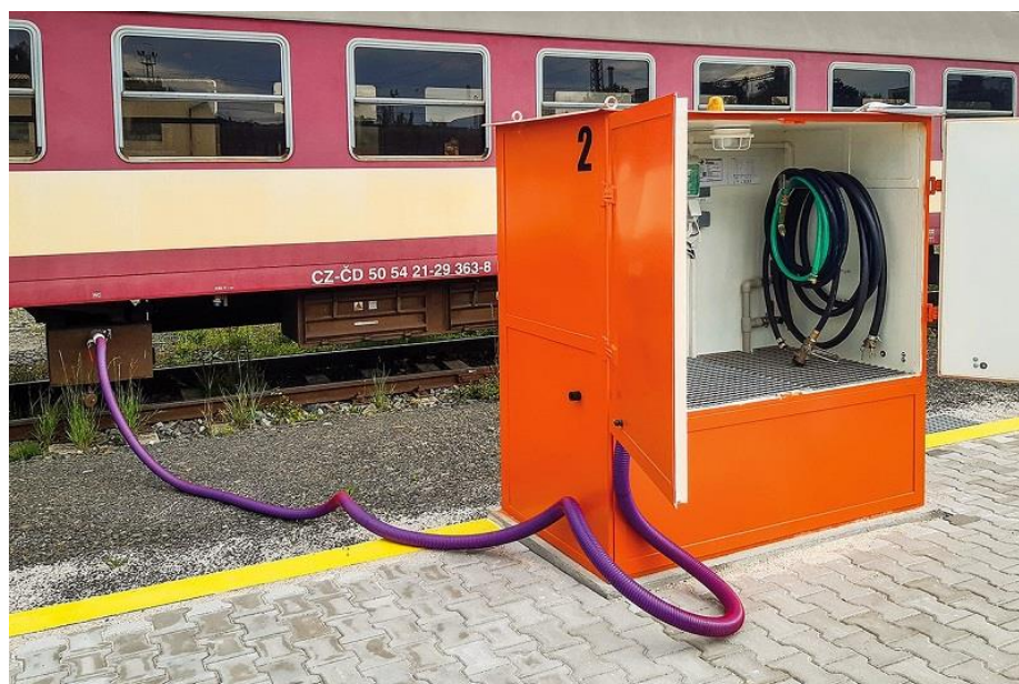
Obrázek 15 - bližší pohled na odsávací skříň nacházející se na nové (2021) sanitární koleji v Klatovech [10]
