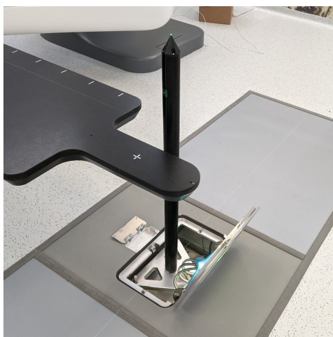
Obrázek 2.1: Instalovaný isopost s isokrystalem v ozařovně. Pod šedými kryty umístěny detektory.
