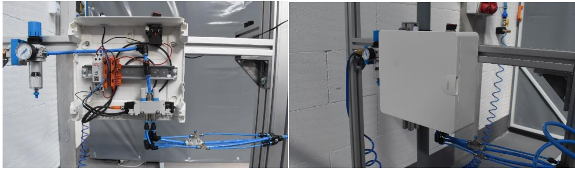
Obr. 39: Uložení ventilů a relé v rozvodné krabici
