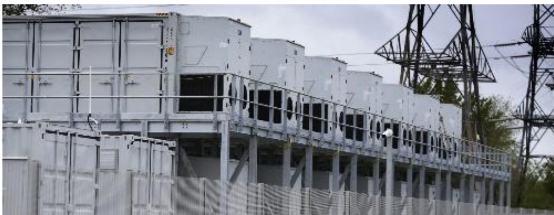
Obr. 11: Využití akumulátorů typu lithium-ion v Pivot Power ve Spojeném království [44]
