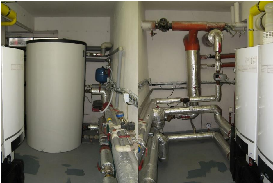
Obrázek 2: Bytový dům č. 1 - kotelna
