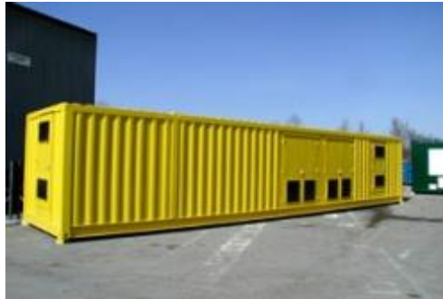
Obr. 38 – Kontejner sloužící jako rozvodna [32]
