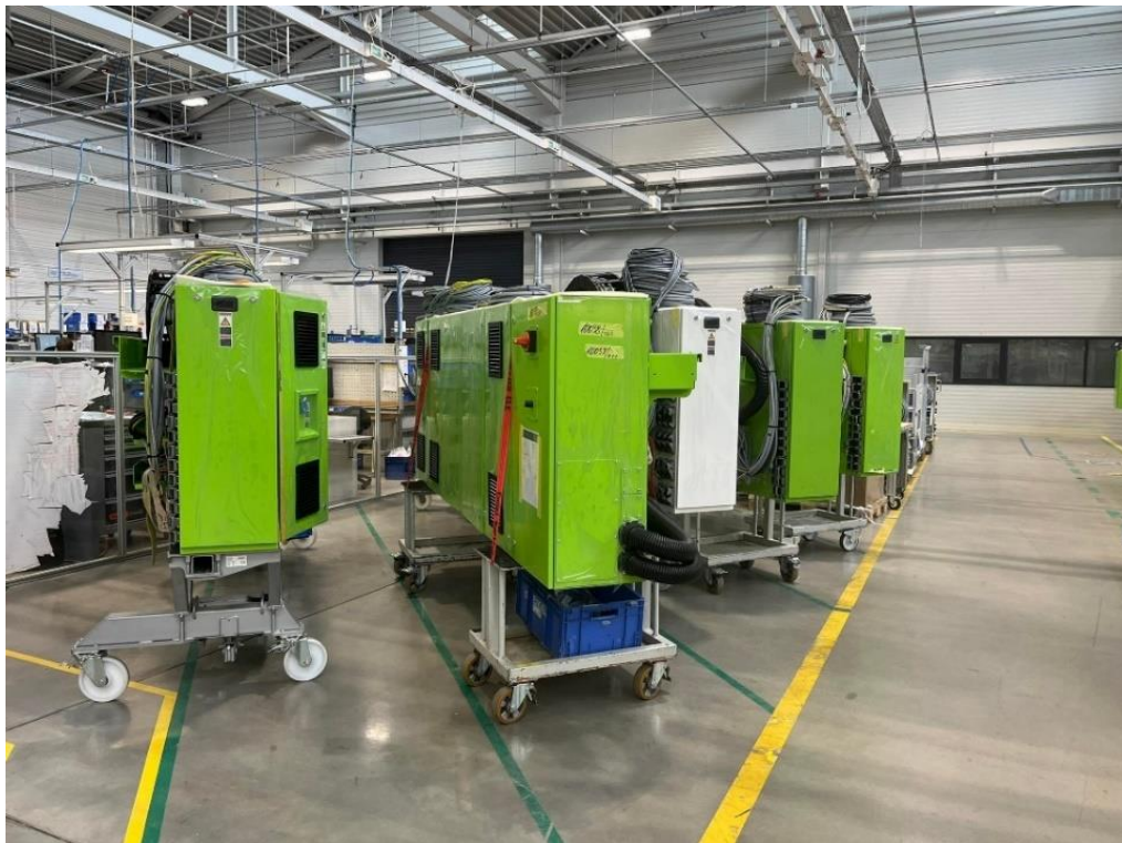
Obr. 8-1 Dokončené rozvádzačové skrine v klasickej 'Engelovskej zelenej farbe' – zdroj: autor
