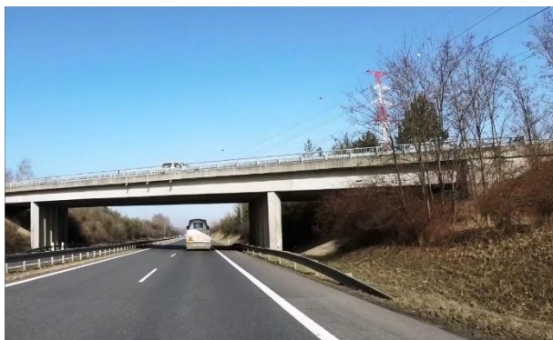
Obrázek 31 – Krátké svodidlo před nosným pilířem mostní konstrukce | TENT-T | D6 | ID 1 031.
