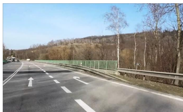
Obrázek 30 – Vzájemně nepropojená ocelová svodidla před mostem | TEN-T | I/3 | ID 13 675.
