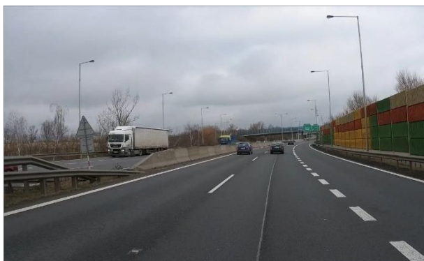
Obrázek 29 – Neadekvátní přechod mezi ocelovým a betonovým svodidlem | TEN-T | DO | ID 211.
