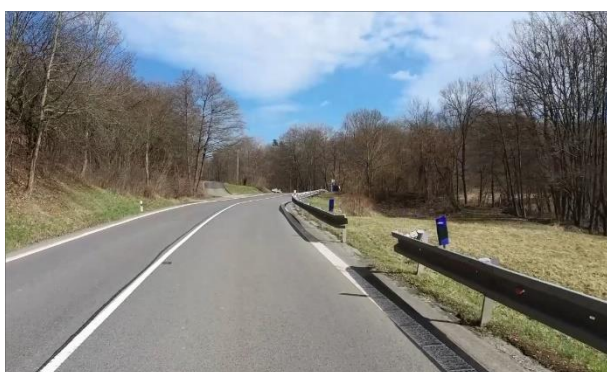
Obrázek 33 – Absence výškového náběhu ocelového svodidla v místě sjezdu | TENT-T | I/49 | ID 8 194.
