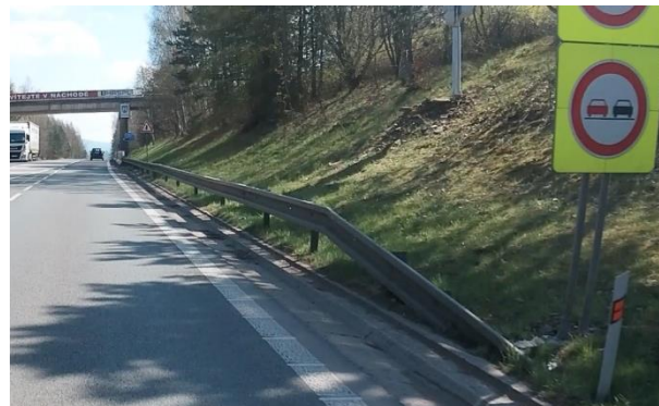
Obrázek 54 – Deficit v extravilánu v místě s nejvyšší dovolenou rychlostí 70 km/h | TEN-T | I/33 | ID 30 877.
