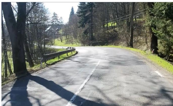
Obrázek 53 – Evidovaná závada v místě s nejvyšší dovolenou rychlostí 50 km/h | TEN-T | I/16 | ID 16 283.
