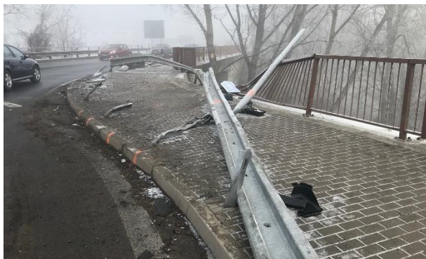
Obrázek 44 – Proražená ocelová svodidla s úrovní zadržení H1. [40]
