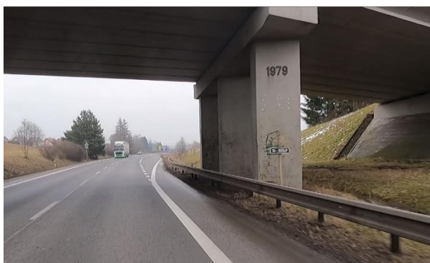
Obrázek 51 – Mostní pilíře umístěn v intervalu (0; ½ PŠ) | TEN-T | I/16 | ID 30 112.
