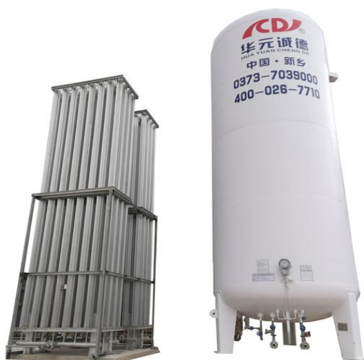
9 Skladovací nádrž na kapalný kyslík [10]
