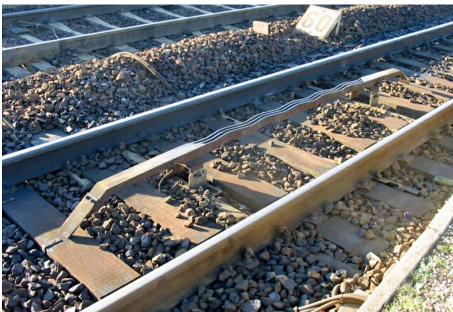
Obrázek 16: Kontakt traťové části bodového zabezpečovače, zdroj: [54]
