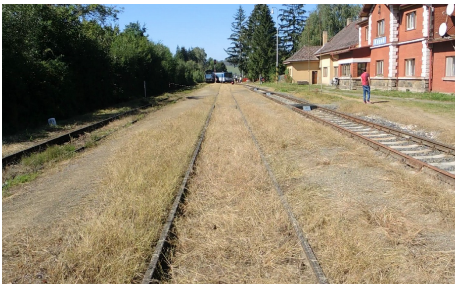
Obrázek 28: Pohled na znečištěnou staniční kolej 2, zdroj: [36]
