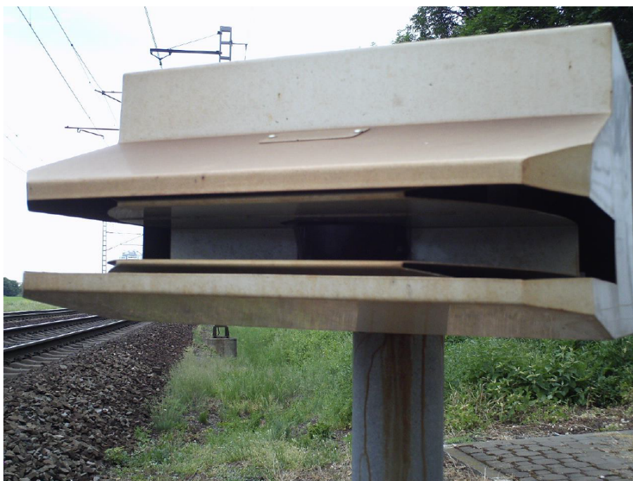
Obrázek 23: Laserový skener SICK instalovaný na přejezdu, zdroj: [26]
