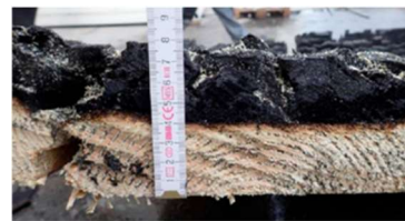
Obr. 59 - zuhelnatění v blízkosti rohu na druhé straně stěny
