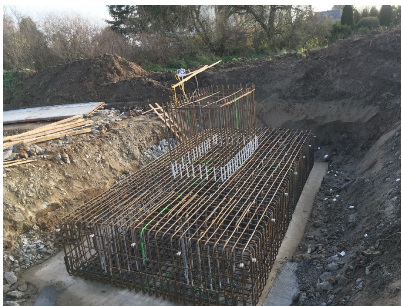
Obr. 25 - Zárodek dřívku na výztuži základu pilíře
