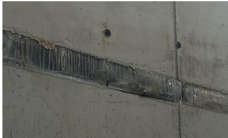
Obr. 3.32 Nevylámané vylamovací lišty pro rampu ve vybetonované stěně
