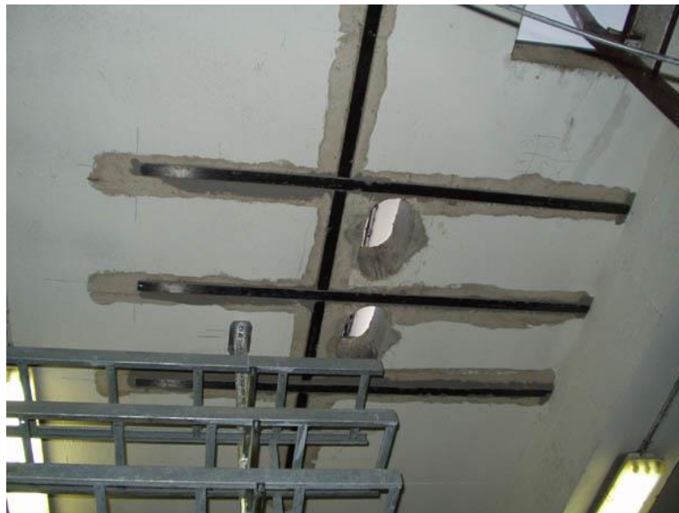
Obr. 2.7 Ztužení stropní desky v okolí dodatečně provedených otvorů [15]
