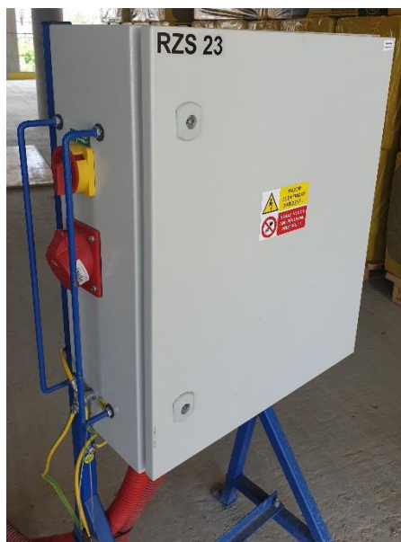
Obrázek 17: Rozvodná skříň s bezpečnostní značkou a nouzovým vypínačem [autor]
