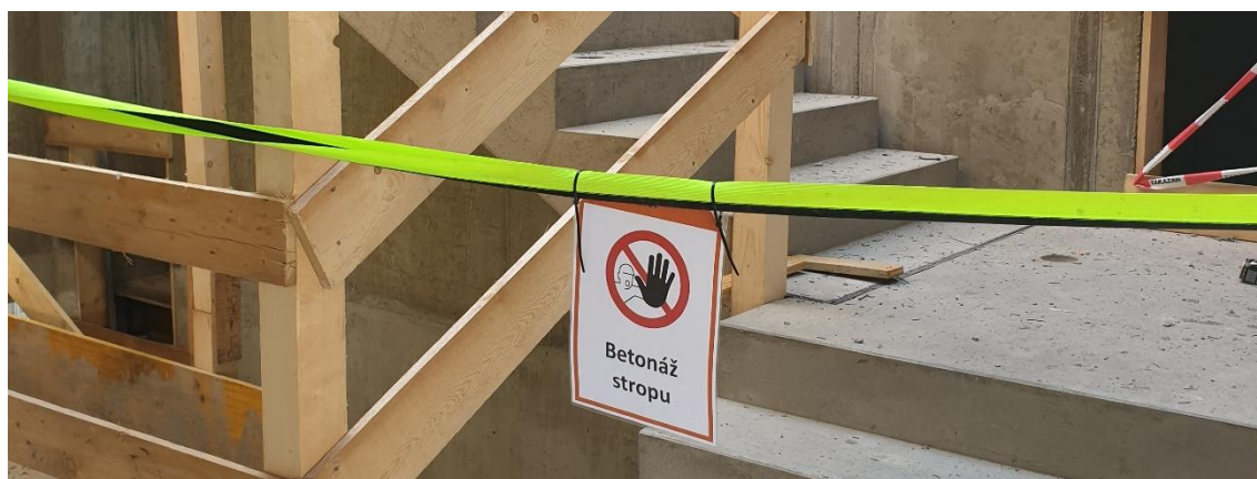
Obrázek 39: Zákaz vstupu pod bednění [autor]
