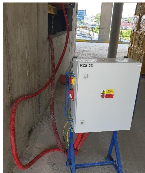
Obrázek 26: Elektro rozvaděč s chráničkami kabeláže [autor]
