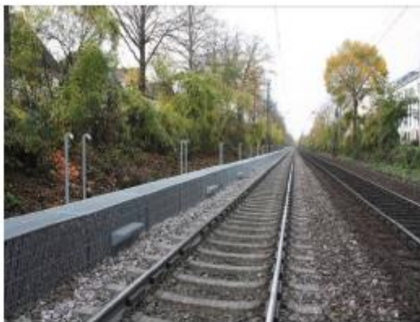
Obrázek 3.23: Gabionová clona FERRONDO silenzio forte [32]
