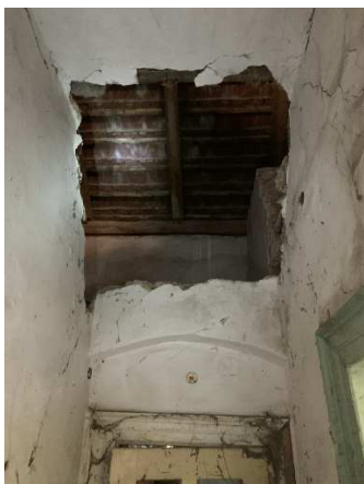
Obr. 90: Propadlé schodišťové rameno zesponu
