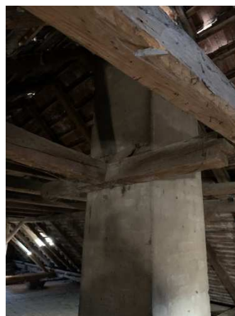
Obr. 89: Výměna s nefunkčním uložením na obou koncích
