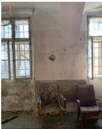
Obr. 65: Pohled I4 - Zvýrazněná vlasová trhlina v nadpraží okna a díra ve stěně
