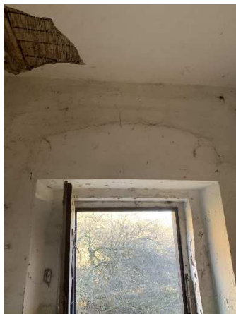
Obr. 56: Oblouková trhlinka v místě překladu dveřního otvoru
