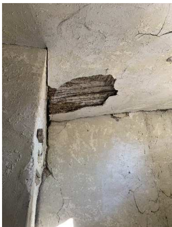
Obr. 78: Trhliny u stěn a opadaná omítka
