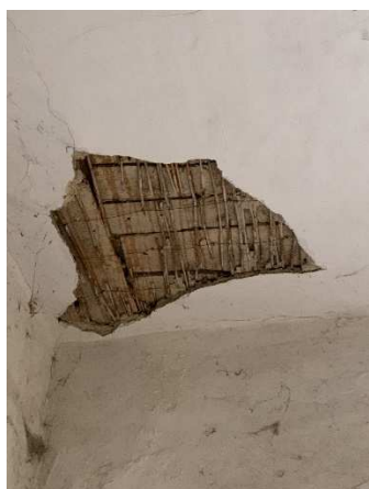
Obr. 81: Opadaná stropní rákosová omítka
