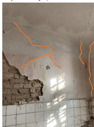
Obr. 64: Zvýrazněná šikmá trhlina a svislá trhlina v rohu místnosti
