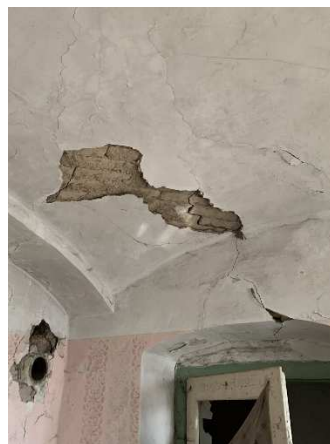
Obr. 75: Trhlinka v levé klenbě s opadanou omítkou
