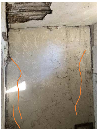
Obr. 47: Pohled A se zvýrazněnými vlasovými trhlinami
