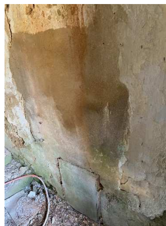
Obr. 71: „Vlhkostní mapa“ a růst řas na vnitřní stěně pod porušeným komínem
