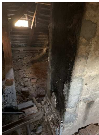
Obr. 95: Zčernalá omítka komínu u poruchy L
