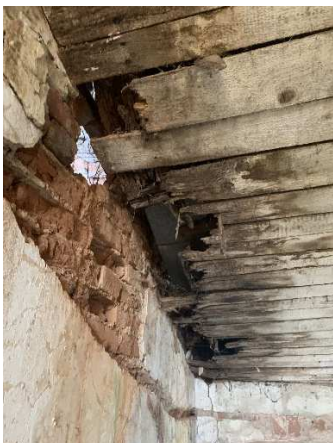
Obr. 79: Latě zasažené dřevokaznou houbou
