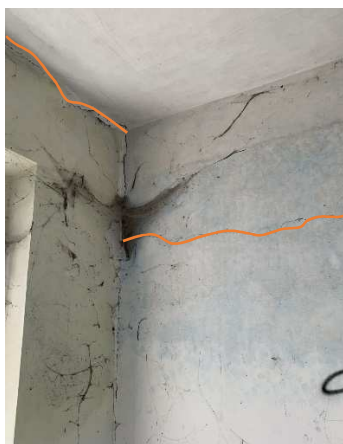
Obr. 54: Svislá rohová trhlina a zvýrazněné trhliny v úrovni stropu a mezipodesty schodiště za stěnou
