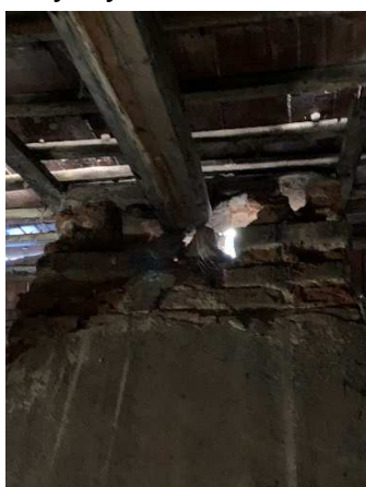
Obr. 84: Porušené zdivo komínu v uložení krokve
