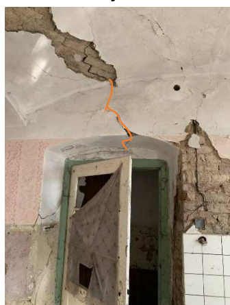
Obr. 63: Pohled I3 – zvýrazněná trhlina nad dveřním otvorem
