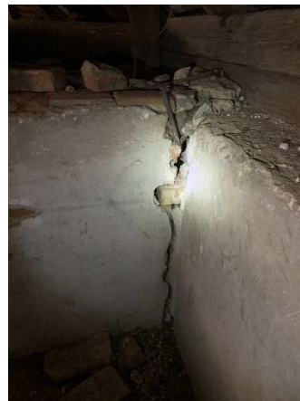
Obr. 92: Trhlina J v místě rohu stěny nad mezipodestou
