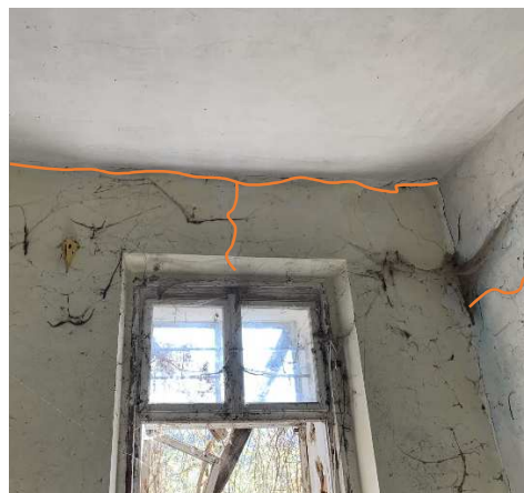
Obr. 55: Trhliny z Obr. X a svislá trhlina v nadpraží okenního otvoru
