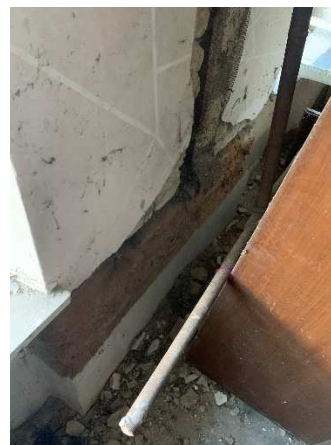
Obr. 68: Pohled E - vodorovná drážka
