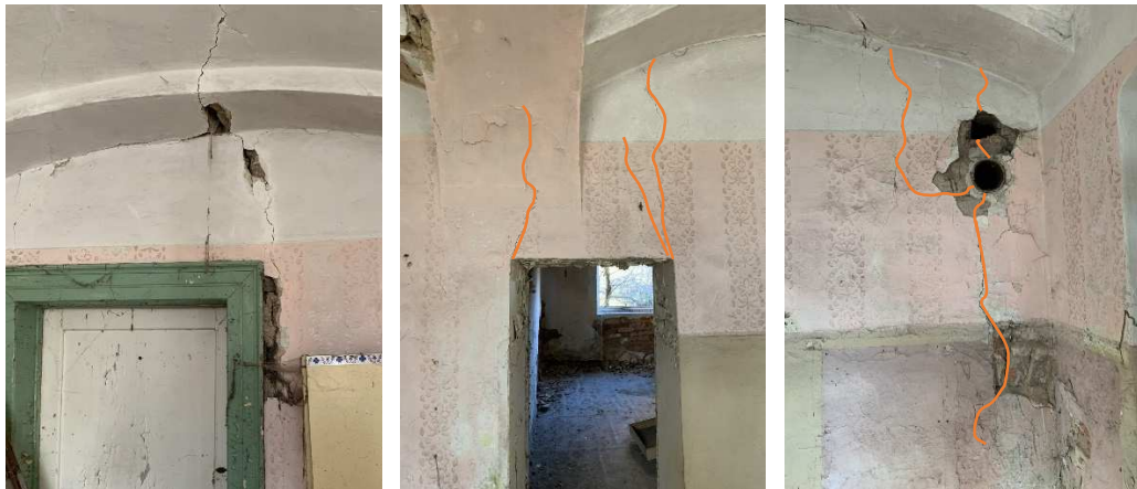
Obr. 60: Pohled I2 - trhlina u levých dveří Obr. 61: Zvýrazněné vlasové trhliny u pravých dveří Obr. 62: Zvýrazněné trhliny v pravé části stěny
