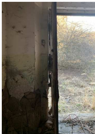
Obr. 57: Narušená pata dveřního rámu
