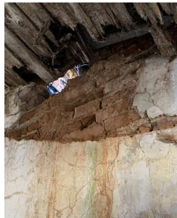
Obr. 99: Otvor ve zdivu s degradovaným podbitím
