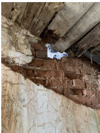
Obr. 93: Porucha zdiva komínu ve východní části objektu
