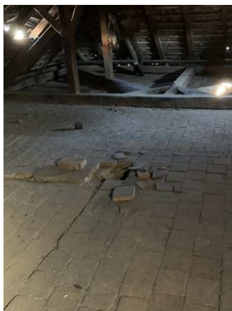
Obr. 82: Porušená podlahová krytina v 2.NP
