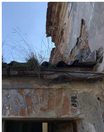
Obr. 97: Netěsné napojení střešního pláště na stěnu
