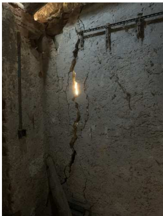
Obr. 51: Pohled C – hlavní trhlina a rohová díra
