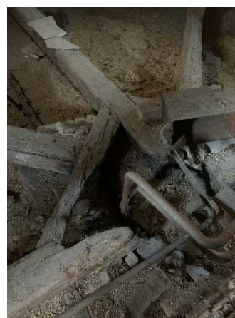
Obr. 86: Požárem poškozený spoj dřevěných trámů
