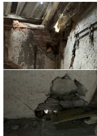
Obr. 53: Rohová díra pod střešním trámem (nahore); díra nad zídkou ve středu stěny (dole)
