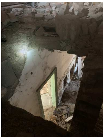
Obr. 91: Propadlé rameno shora; narušené nadezdívky
