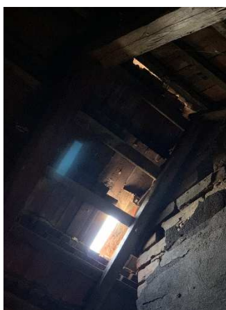
Obr. 85: Porušená střešní krytina
