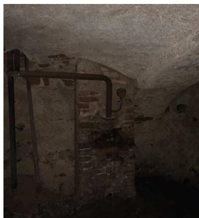
Obr. 45: Opadaná omítka na suterénní stěně velkého sklepu
