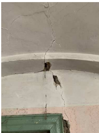
Obr. 74: Trhlinka přes podélný klenební pás
