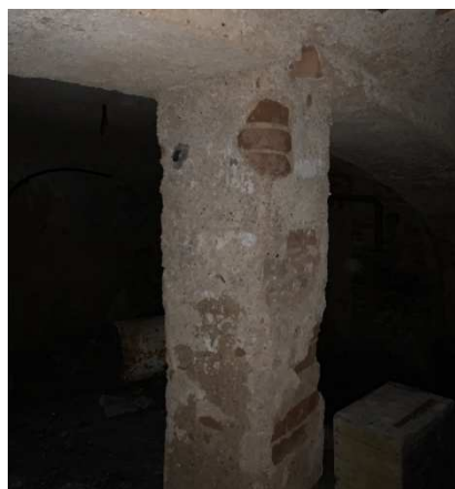
Obr. 44: Opadaná omítka na zděném sloupu ve velkém sklepu
