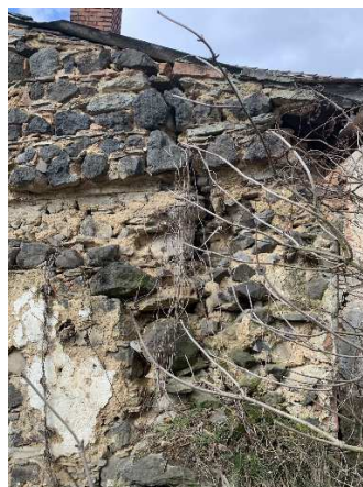
Obr. 52: Hlavní trhlina z exteriéru
