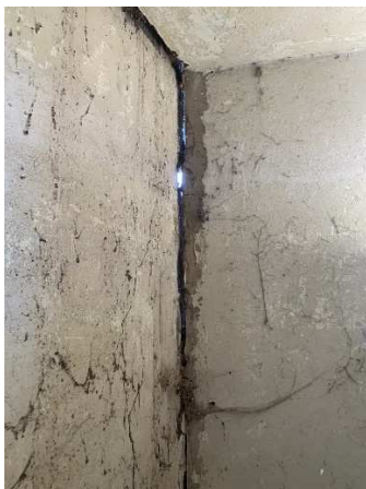
Obr. 48: Svislá trhlina v jiho-východním rohu budovy
