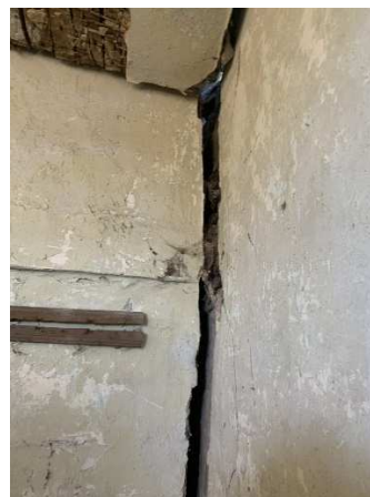
Obr. 49: Svislá trhlina mezi obvodovou a vnitřní stěnou
