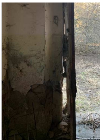
Obr. 70: Opadaná vnitřní omítka a vydrolená malta
