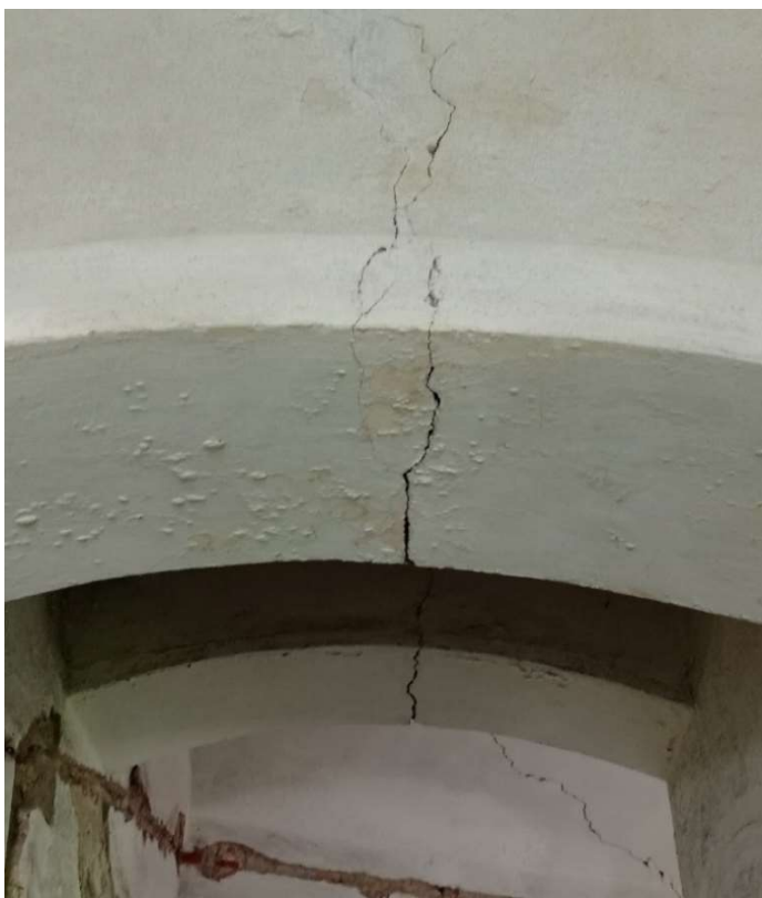
Obrázek 32 – Porucha P20 – Trhlina v hlavě klenby nad schodištěm
