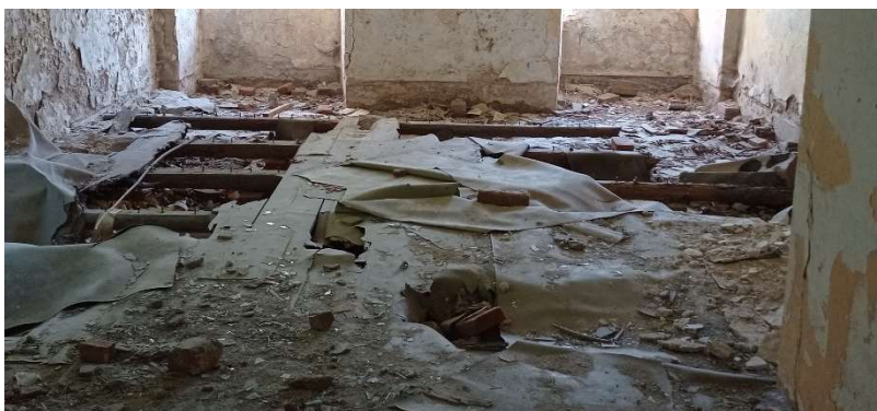
Obrázek 44 - Porucha P06 – Propadlá podlaha
