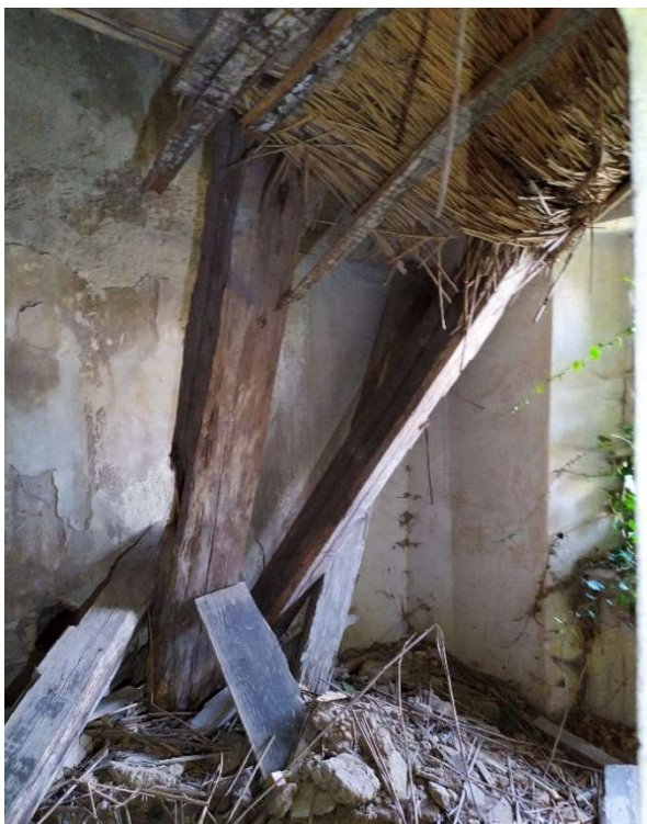
Obrázek 33 – Porucha P50 – propadlý podhled
