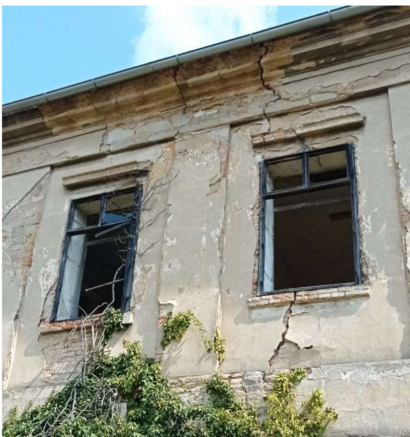
Obrázek 24 - Příklad trhliny v západní fasádě
