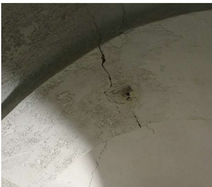
Obrázek 31 – Porucha P21 – Trhlina v hlavě klenby
