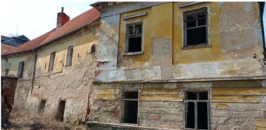
Obrázek 48 - Poškození fasádních omítek
