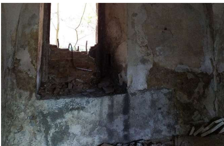
Obrázek 28 – Porucha P75 – vlhkost obvodového zdiva
