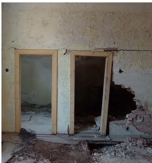
Obrázek 40 - Porušení zárubně v důsledku poruchy příčky
