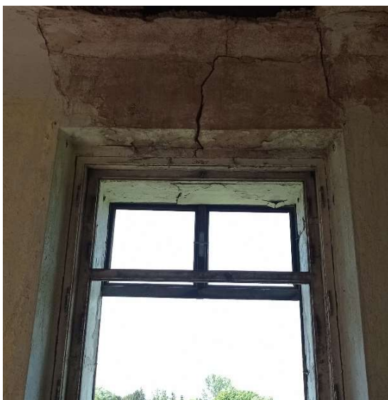
Obrázek 25 – Porucha P25 – trhлина nadpraží
