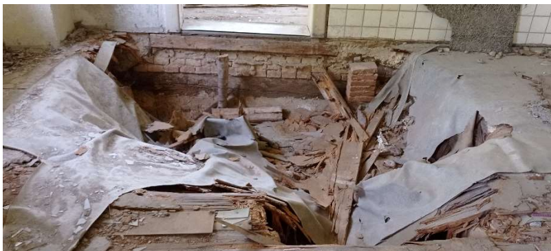
Obrázek 45 - Porucha P34 – propadlá podlaha
