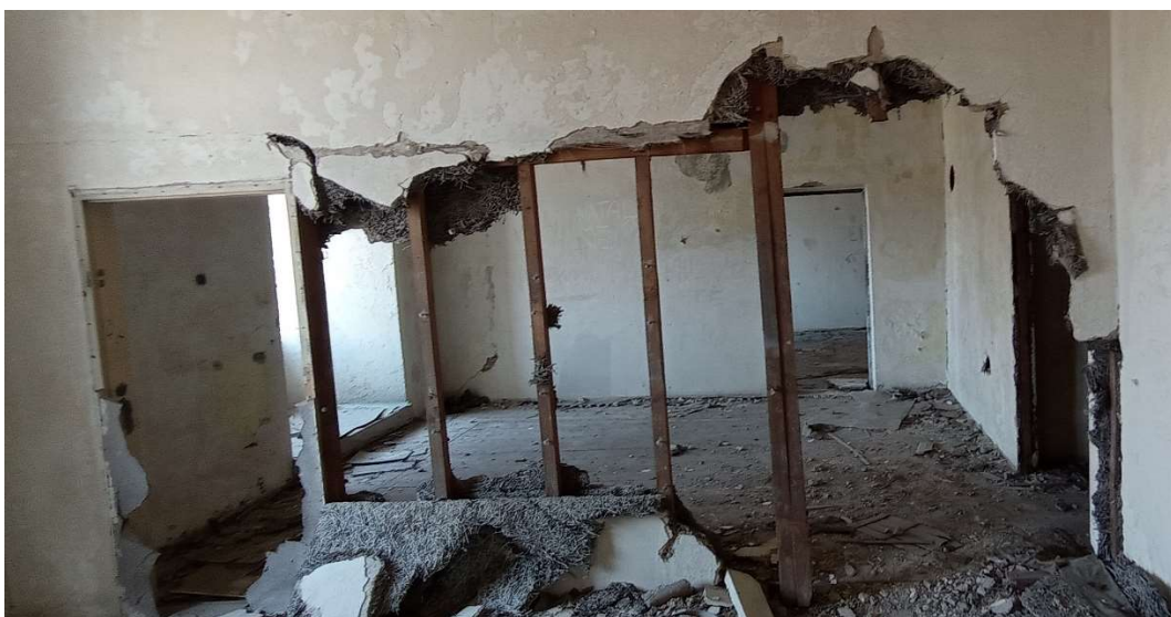
Obrázek 43 - Porucha P83 – porušení příčky
