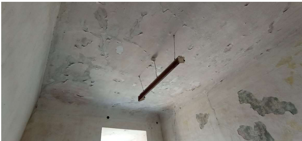
Obrázek 47 - Poškození vnitřních omítek
