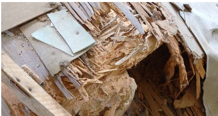
Obrázek 46 - Porucha P34 – degradace dřevěného trámu
