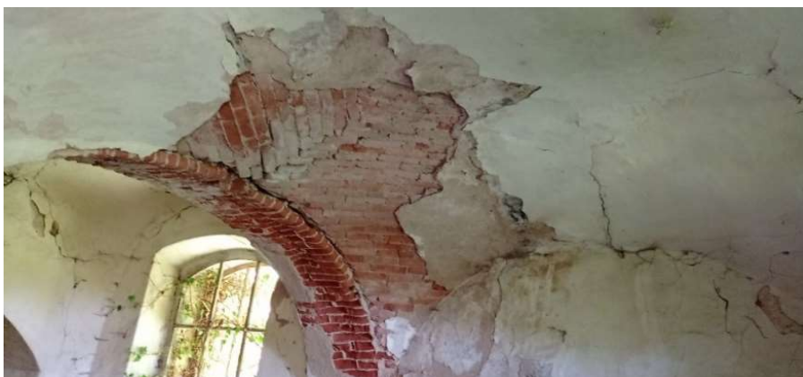
Obrázek 30 – Porucha P70 – Trhlina v klenbě s projevem vlhkosti v místnosti číslo 117
