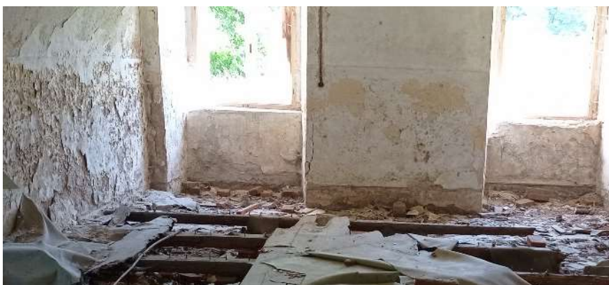
Obrázek 27 – Porucha P80 – vlhkost obvodového zdiva
