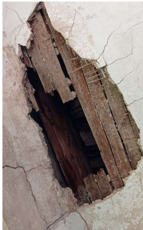
Obrázek 34 – Porucha P26 – propadlý podhled
