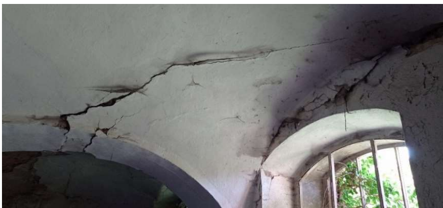
Obrázek 29 – Porucha P68 – Trhlina v klenbě v místnosti č. 117
