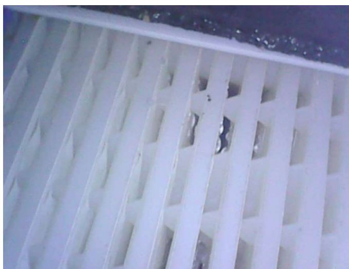
Obrázek 33: Námraza na vstupu odváděného proudu I1 do výměníku, která se rozšířila v průběhu měření od výstupu I2. Zdroj: archiv autora
