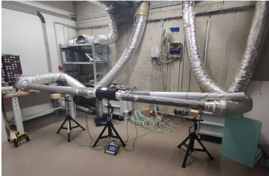
Obrázek 19: Měřený výměník tepla napojený na testovací linku, zdroj: archiv autora
