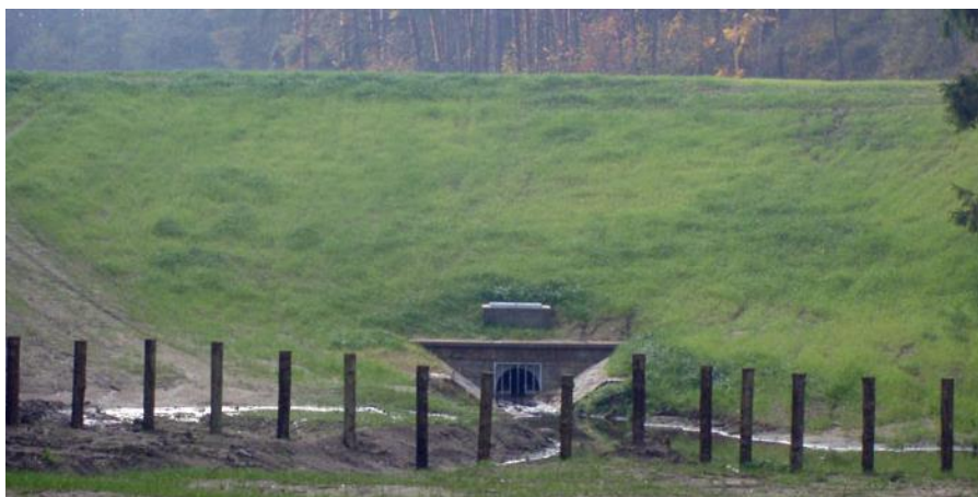
Obr. 9 – Výpust s ponořeným vtokovým objektem u suché nádrže Březinka [16] (pozn. obrázek zmenšen)
