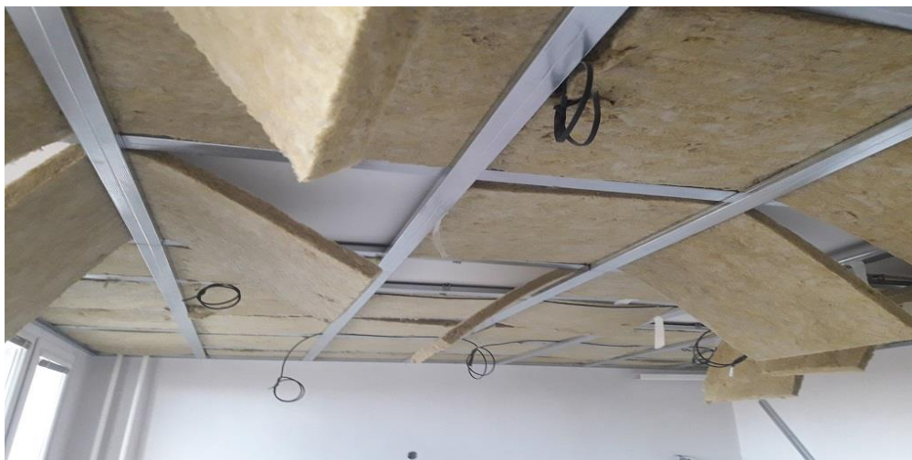
Obr. č. 23 – Provedení SDK podhledu s akustickou izolací z MW Zdroj: Foto autora
