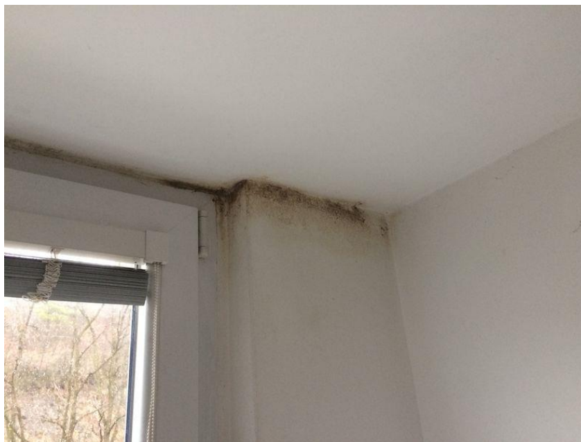
Obr. č. 14 – Plísň v rohu u styku stěny a stropu
