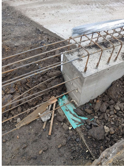
Obrázek 17: Pracovní spára v základovém pasu, vlastní zpracování
