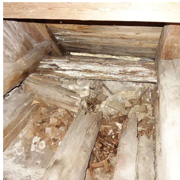
obrázek 33 – rozsáhlé poškození trámového zhlaví trámů stropu hlavní lodi
