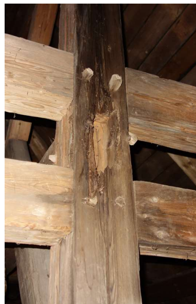
obrázek 41 – porušení středního vodorovného prvku středního ztužidla
