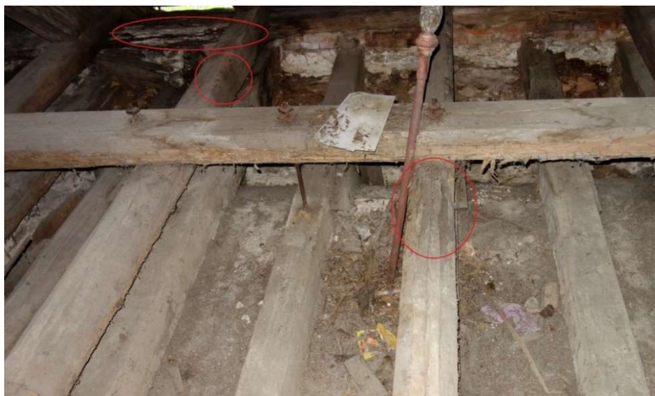
obrázek 38 – oslabení vazných trámů a pozednice zatékáním
