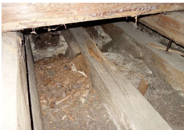
obrázek 30 – ztrouchnivělý stropní trám
