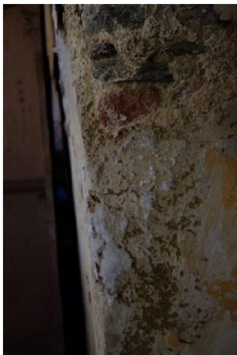
obrázek 19 – solný výkvět na nosné stěně v přízemí
