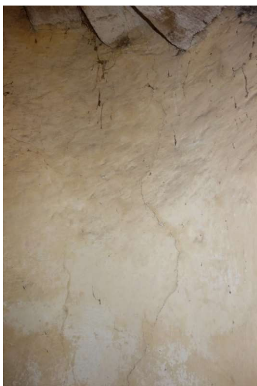
obrázek 20 – trhlina ve stěně u točitého schodiště
