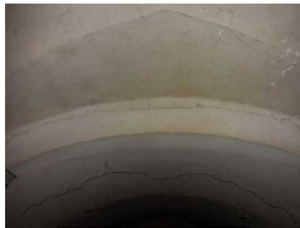
obrázek 35 – trhliny v klenbě u varhanniště
