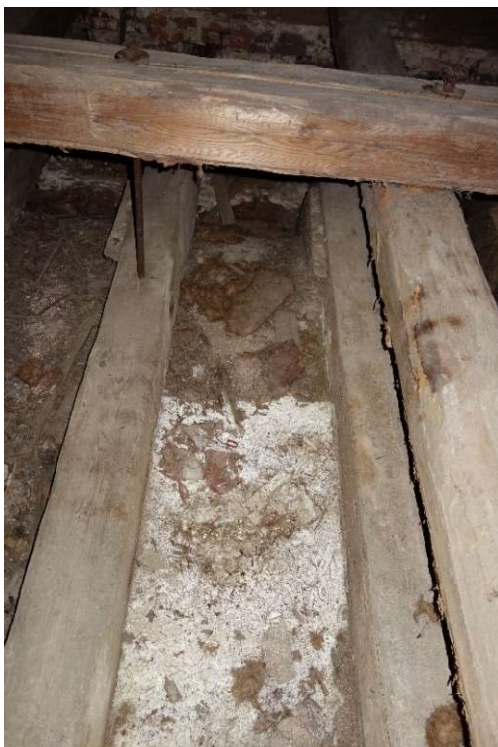
obrázek 32 – plíseň stropní konstrukce hlavní lodi
