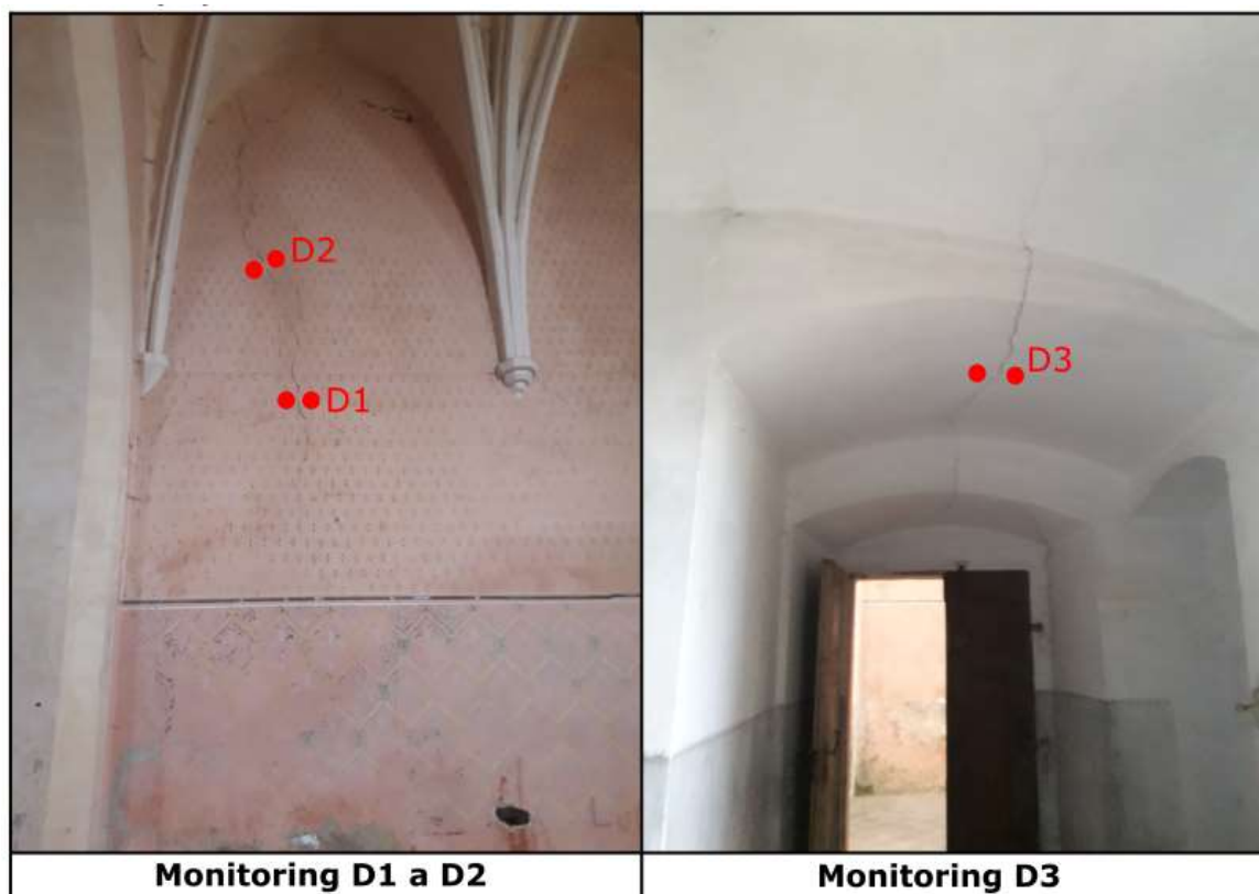
obrázek 28 – lokace měřících bodů pro monitoring trhlin
