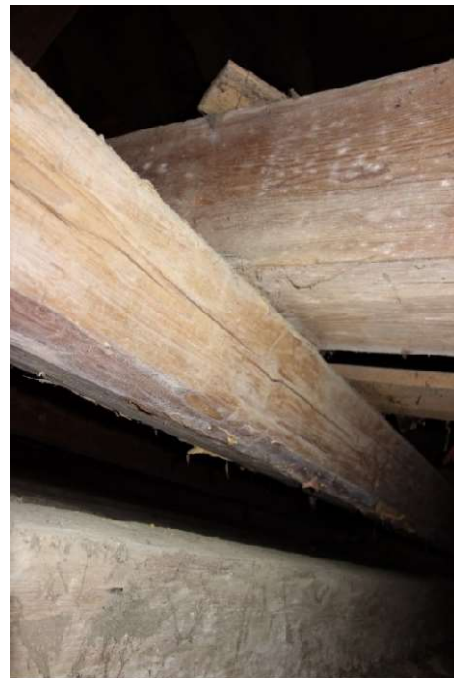
obrázek 14 – pohled zespodu na uložení spodního podélného prvku středového ztužidla na vazné trámy
