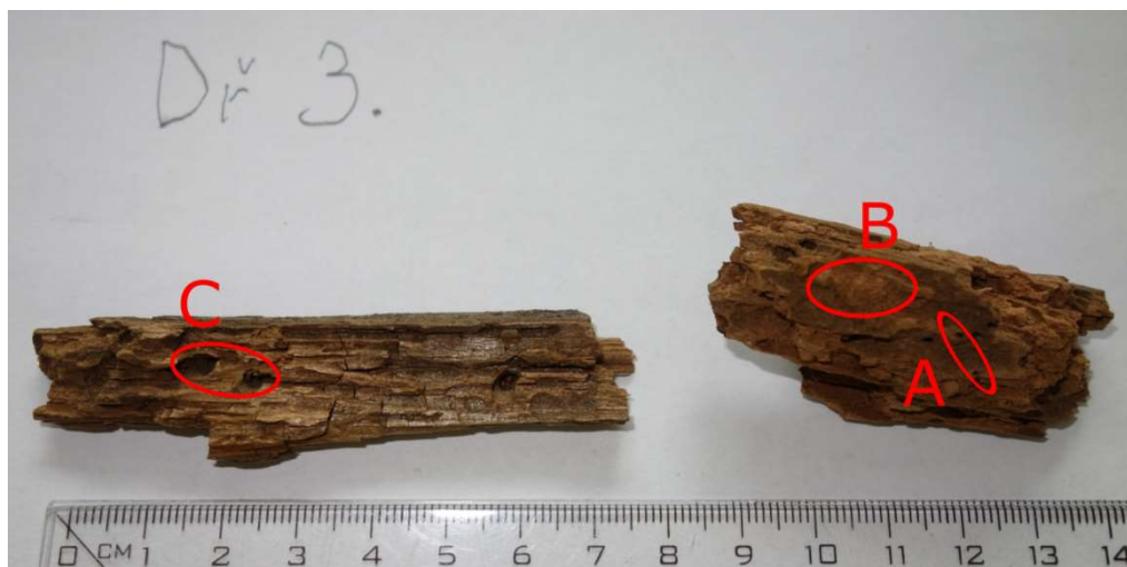
obrázek 29 – vzorek zhlaví stropního trámu, napadení dřevokazným hmyzem
