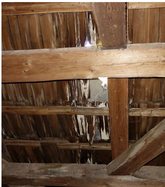
obrázek 40 – narušená střešní krytina
