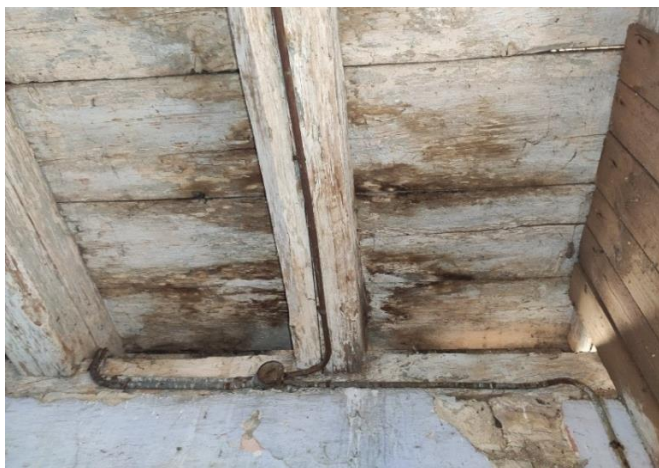
Obr. 57 Degradace stropu věže
