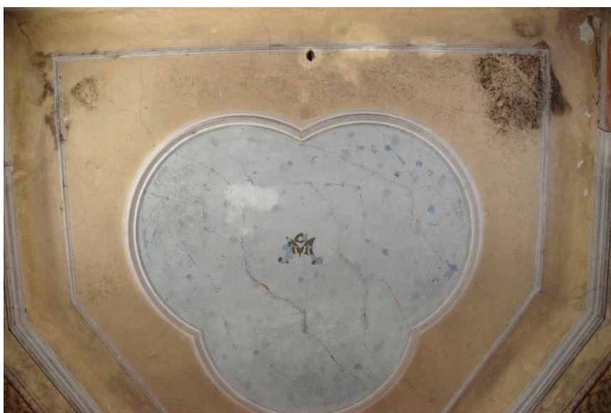
Obr. 52 Plísně na omítce – presbytář
