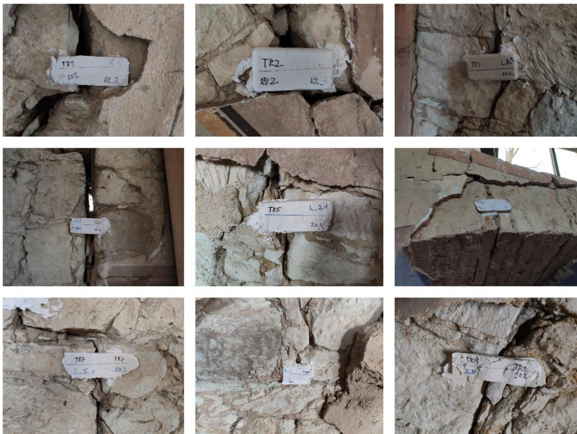
Obr. 73 Souhrnné foto všech monitorovaných trhlin – stav k 20.2.2022
