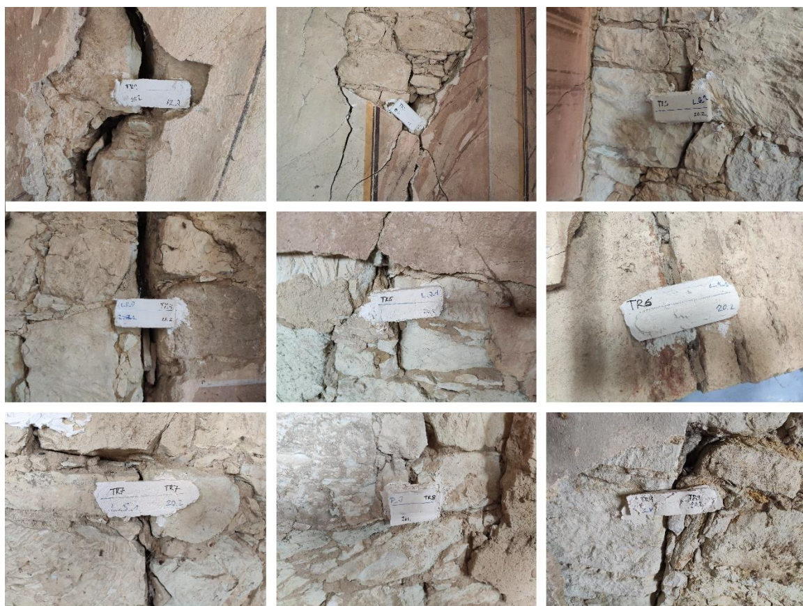
Obr. 74 Souhrnné foto všech monitorovaných trhlin – stav k 14.4.2022
