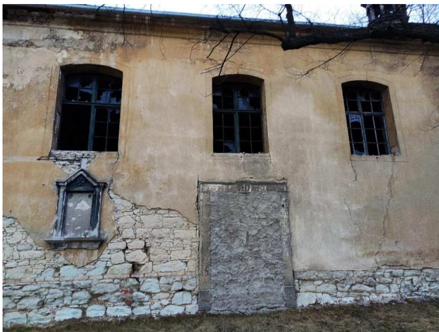
Obr. 43 Trhliny okolo otvorů
