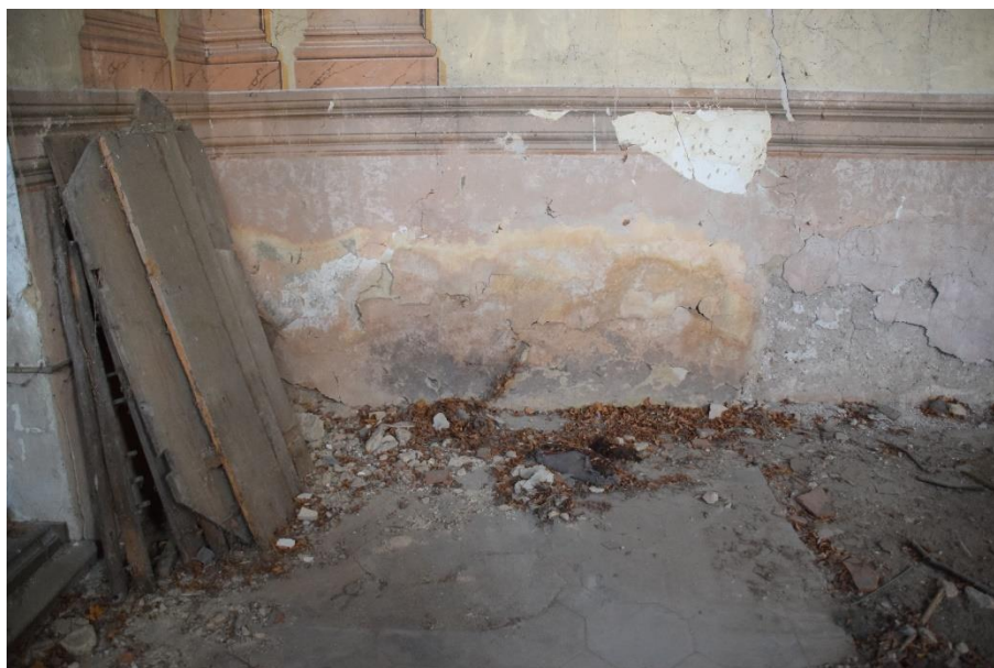
Obr. 45 Vlhkost soklu – interiér
