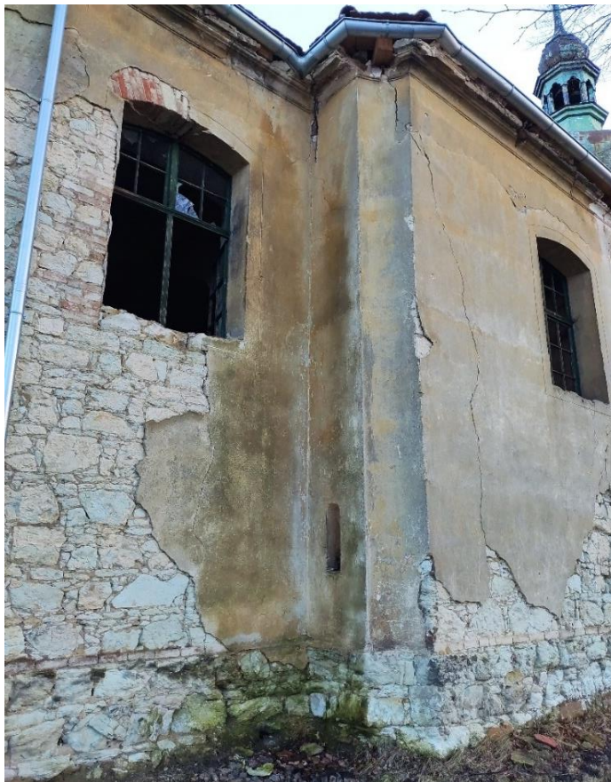
Obr. 44 Porušený okap a vlhká omítka po dešti dne 17.2.22
