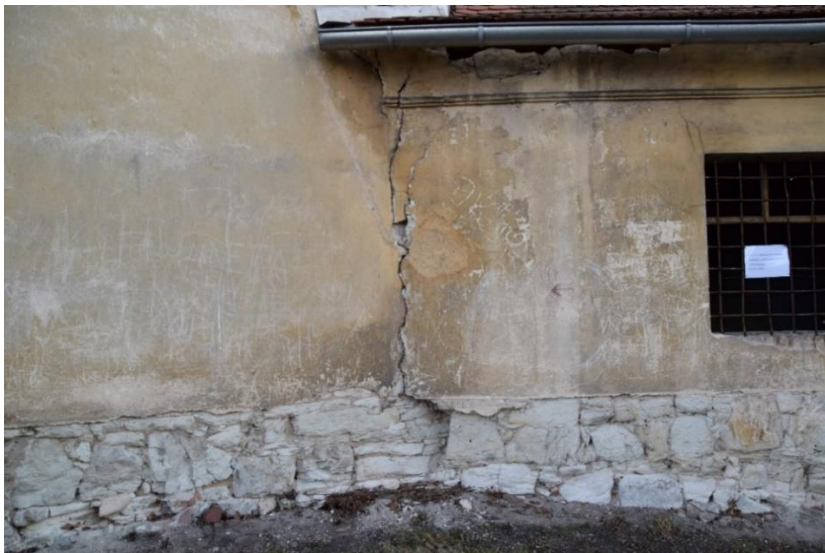
Obr. 46 Trhlina na pomezí sakristie a presbytáře
