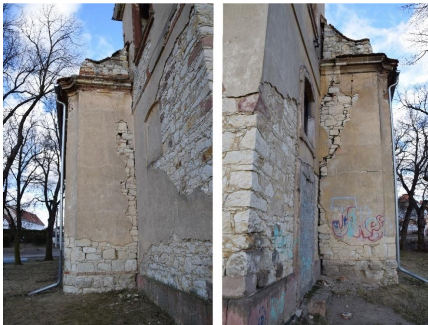
Obr. 40, 41 Trhliny na pomezí lodě a věže
