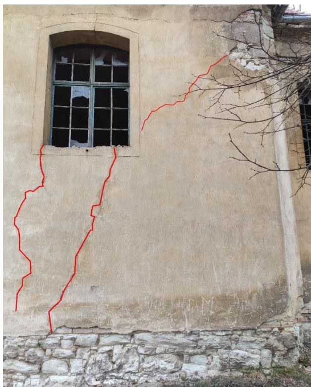
Obr. 39 Trhliny z důvodu poklesu základové spáry
