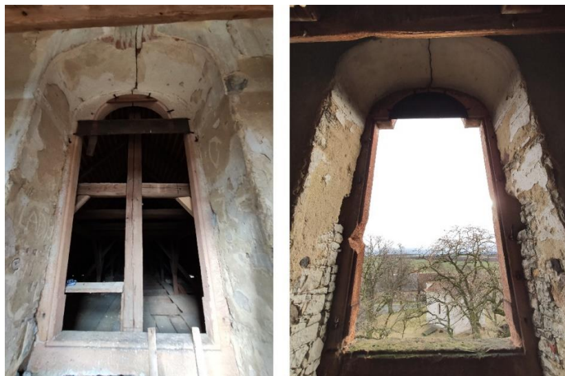
Obr. 47, 48 Rozevření spáry nad okny
