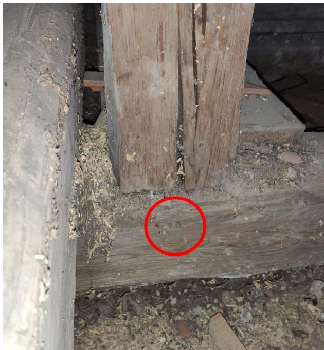
Obr. 59 Chybějící dubový kolík sloupku a vazného trámu
