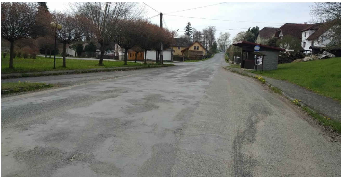
Obrázek číslo 34: Stav komunikace III. třídy v intravilánu obce
