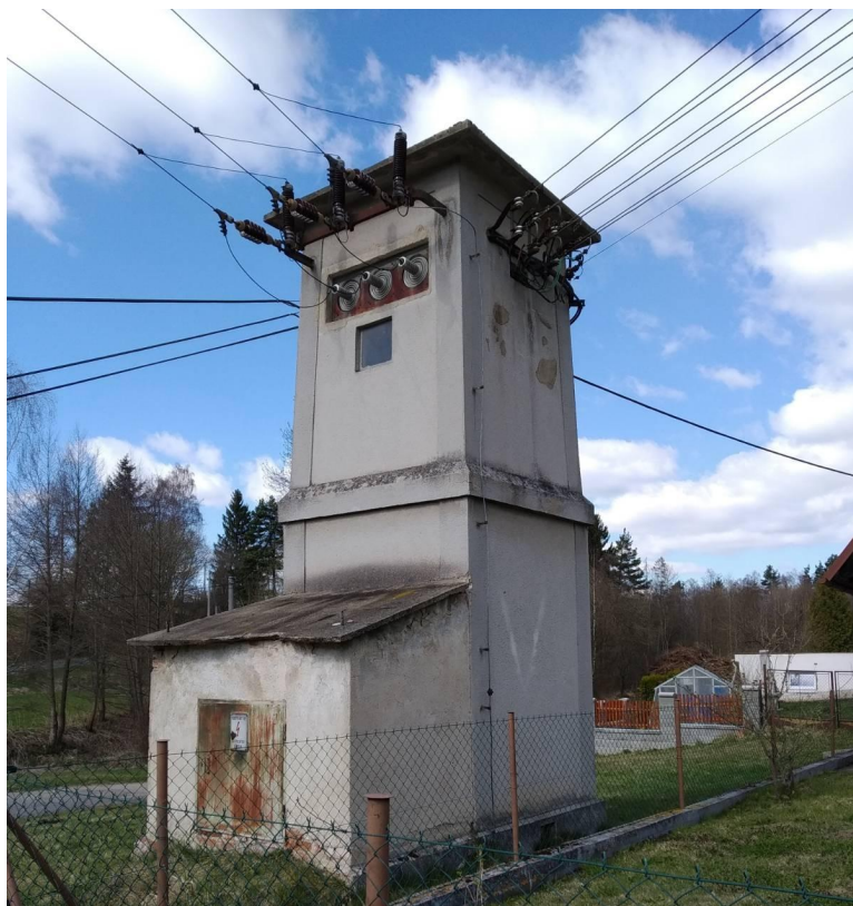
Obrázek číslo 22: Trafostanice v západní části obce
