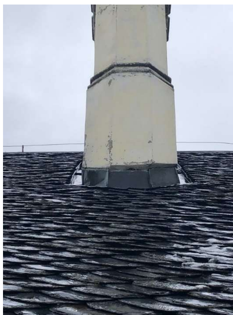
Obrázek 24 - Degradace lemování a komínu
