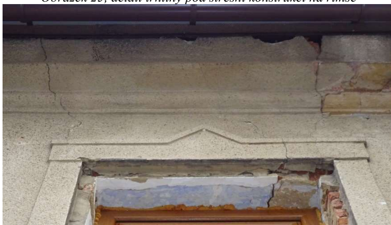
Obrázek 26, detail trhlín u okenního otvoru od vazných trámů a kráčat
