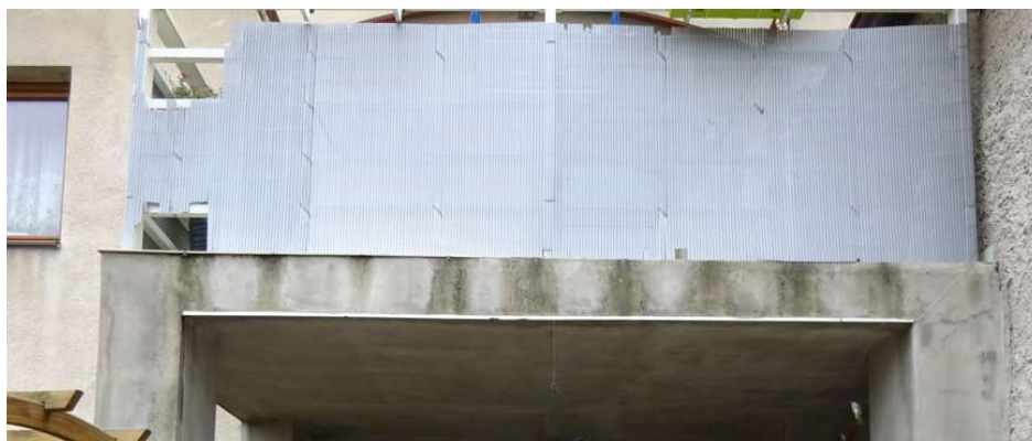
Obrázek 39, skvrny na stropní konstrukci terasy
