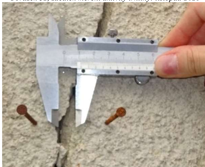
Obrázek 33, konec měření aktivity trhliny: květen 2022
