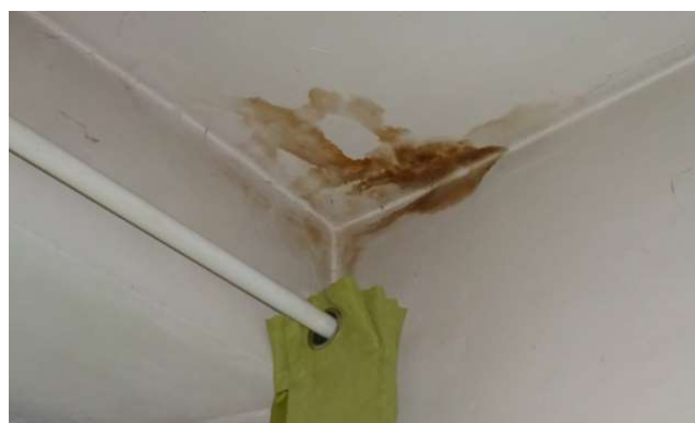
Obrázek 31, skvrna v rohu stěny kuchyně
