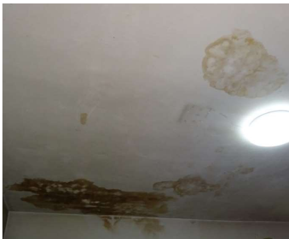
Obrázek 34, svrny na stropní konstrukci v kuchyni
