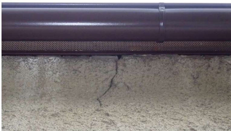
Obrázek 25, detail trhliny pod střešní konstrukcí na římsě
