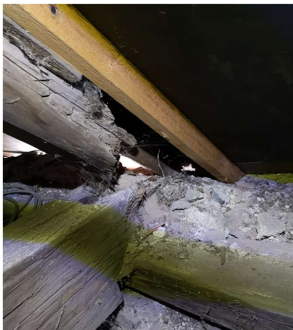
Obrázek 36, částečně uhnílá krokev a vazný trám
