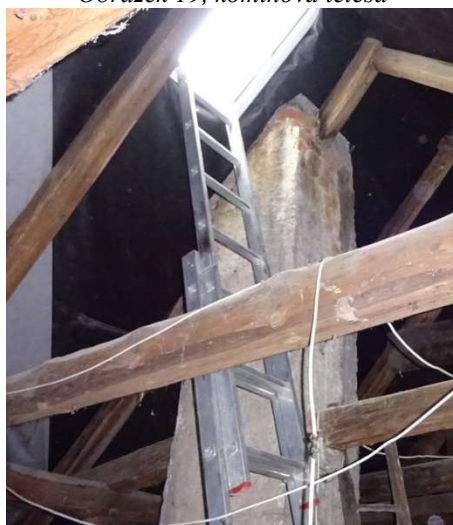
Obrázek 20, vada komínového tělesa
