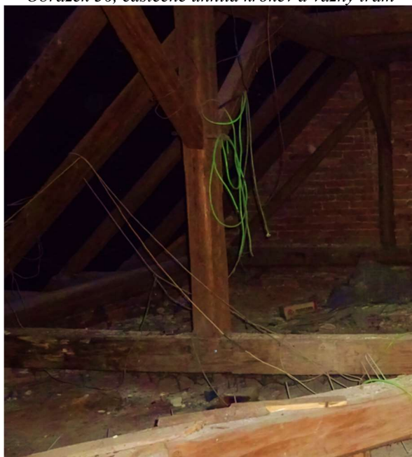
Obrázek 37, částečně shnilý vazný trám
