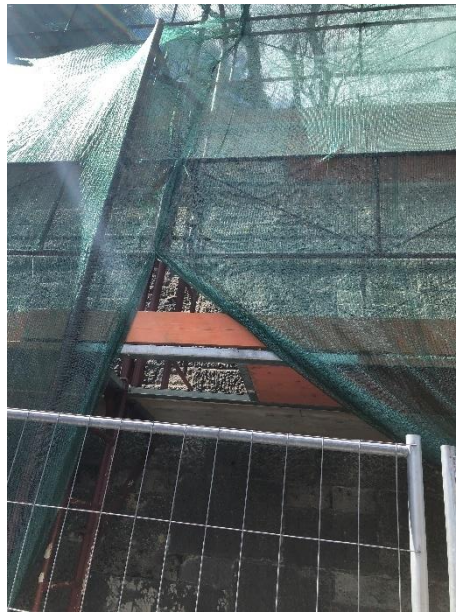
Obrázek 63- Chybně osazené průlezy
