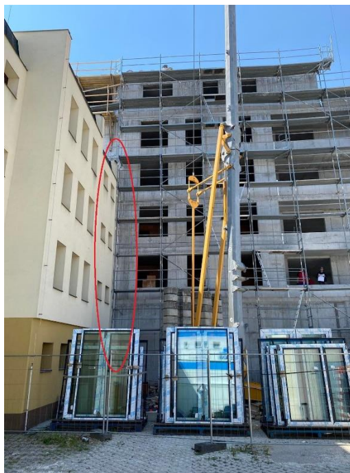
Obrázek 62- Špatné založení lešení
