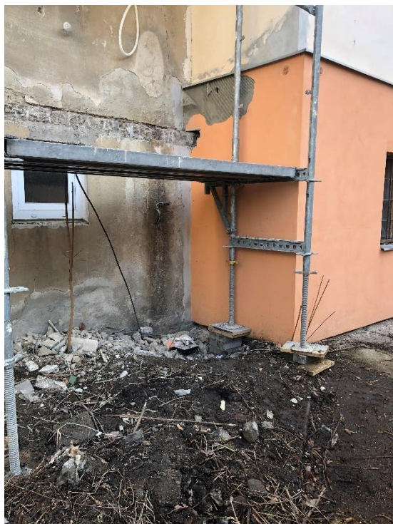
Obrázek 58- Nevhodné podložení patek
