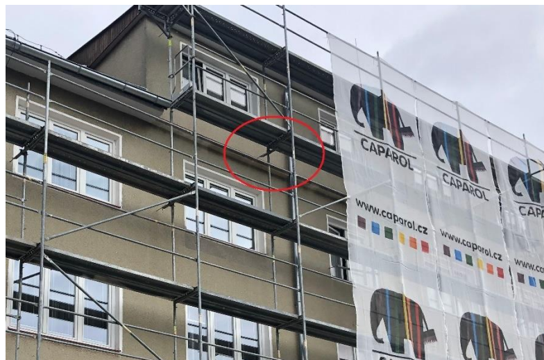
Obrázek 66- Chybně namontovaná kotva
