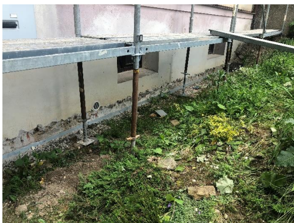
Obrázek 54- Špatné provedení alternativního založení
