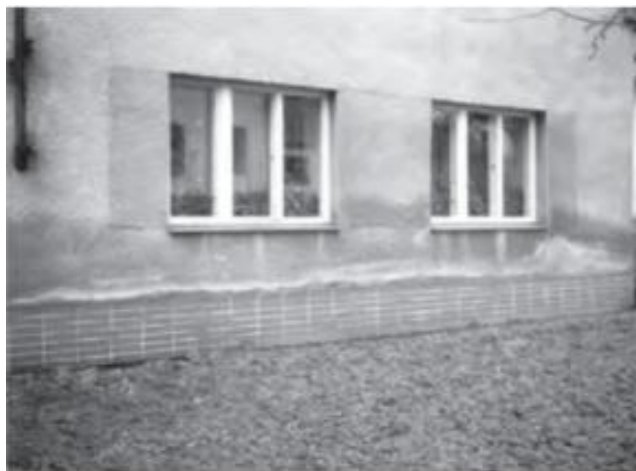
Obr. č. 3 - Objekt s převládajícím výskytem vztlínající vlhkosti (zdroj [2])
