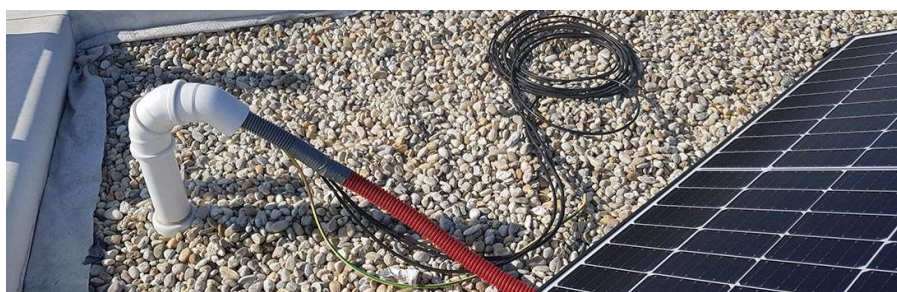
Obr. 9 - Prostup pro kabely na ploché střeše
