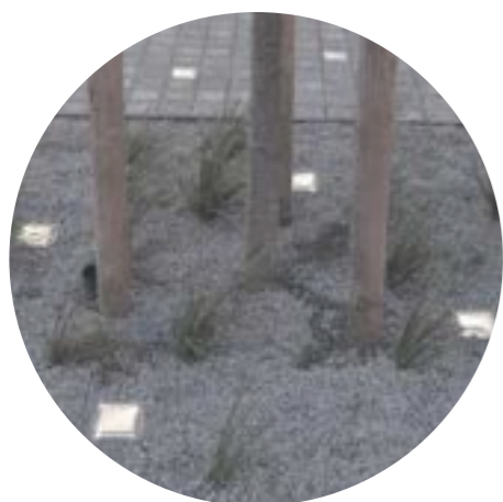
h. veřejné osvětlení umístěné v pochozí rovině, použití u stromů a v ulici mezi objekty innocubu, přisvětlení ulice reflektory umístěnými na lávkách – outsider sunstone
