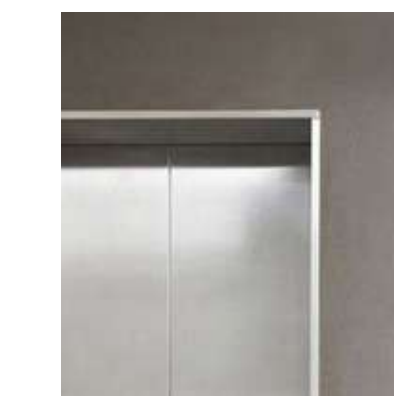
07 DVEŘE VÝTAHŮ NEREZOVÁ OCEL
