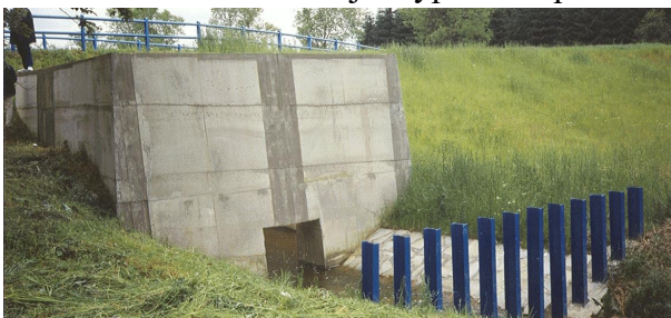
Obrázek 1 – Příklad opatření proti zanášení výpustního zařízení Zdroj: https://strednicechy.ochranaprirody.cz/res/archive/213/071162.pdf?seek=1585907111
