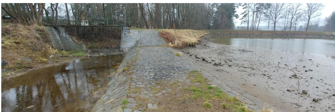
Obrázek 76 – Bezpečnostní přeliv Cihelského rybníka plnící funkci rozdělovacího objektu pro transformaci povodňové vlny v nádrži Zdroj: Autorská fotografie
