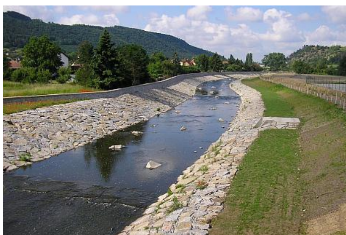
Obrázek 105 – Příklad NEVHODNĚ řešené úpravy koryta v intravilánu Zdroj: https://www.4stav.cz/protipovodnova-opatreni-na-rece-litavce-v-kralovem-dvore-u-berouna_4c3825
