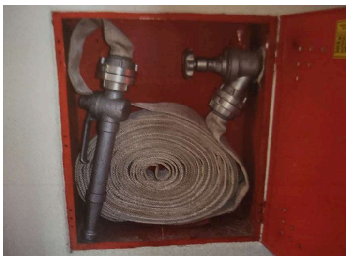
Obrázek 16. Pohled do nástěnného hydrantu se zploštitelnou hadicí [1]
