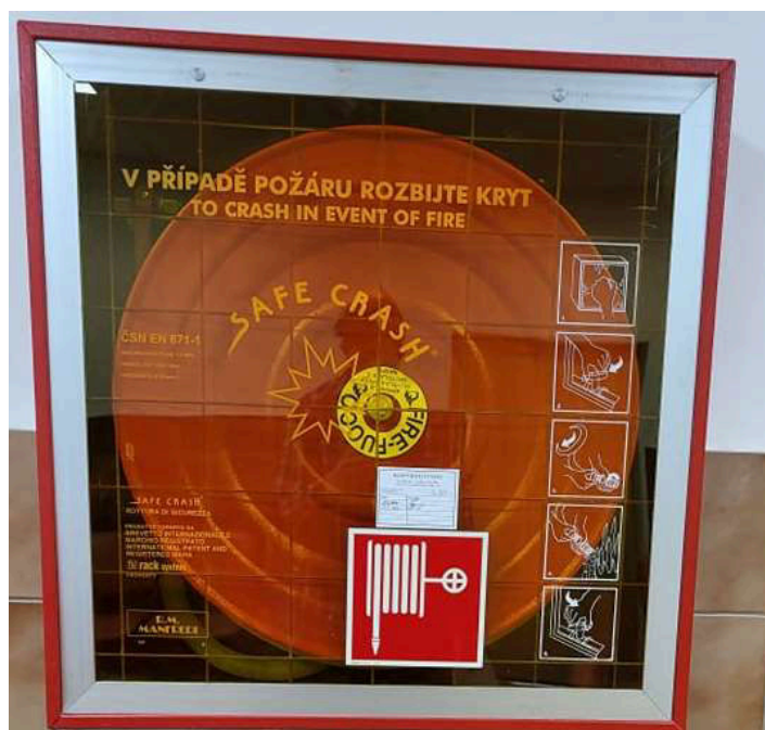
Obrázek 17. –Nástěnný hydrant s tvarově stálou hadicí [vlastní foto]
