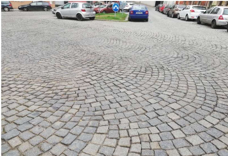
Obrázek 5- vyjeté koleje v dlažbě v křižovatce, zdroj [3]
