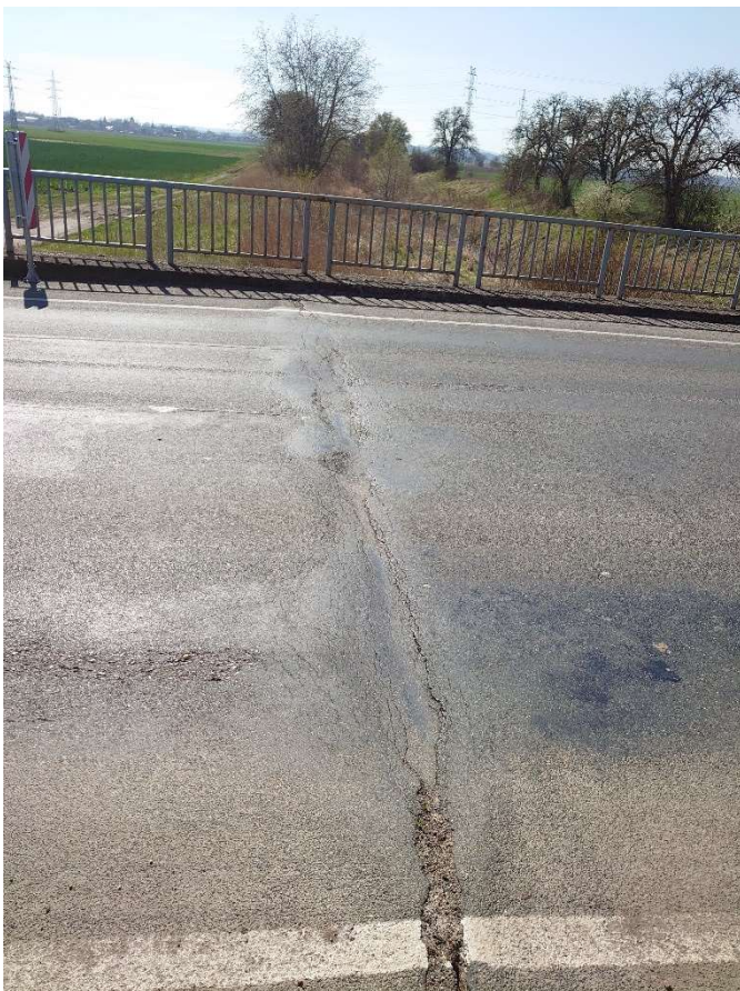
Fotografie č.27 – porucha vozovky na stávajícím mostě přes Vavřínecký potok
