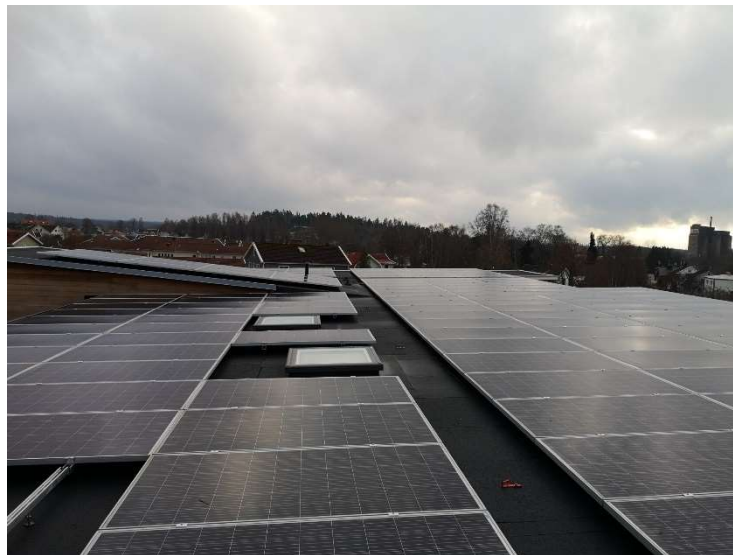
Obrázek 37: Střechu každé renovované budovy pokrývá 500 metrů čtverečních fotovoltaických solárních panelů s výkonem 109 kWp při maximálním solárním přítlaku – roční produkce 98 000 kWh
