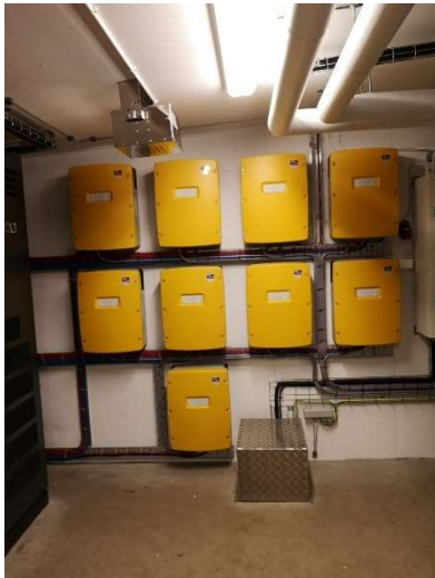
Obrázek 38: Invertory v suterénu přeměňují stejnosměrný proud ze solárních panelů do bateriového úložiště a převádějí ho na střídavý, a ten je dále distribuován do budovy
