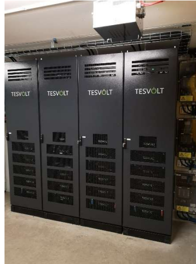
Obrázek 39: Lithiová baterie má kapacitu 187 kWh a zásobuje budovu teplem až po dobu 48 hodin. Zároveň ukládá přebytečnou solární energii až do plného nabytí a ta je poté směřována do elektrolyzérů plnící vodíkový zásobník
