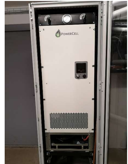
Obrázek 40: Vzniklé teplo z palivového článku se využívá v systému ústředního vytápění budovy
