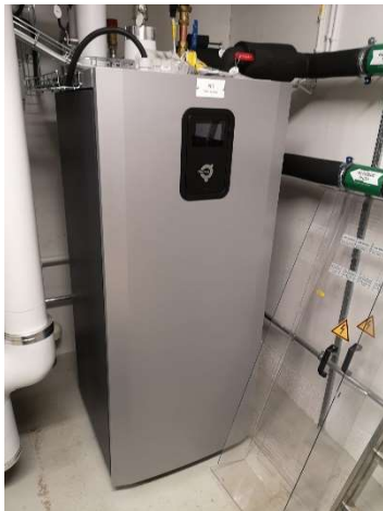
Obrázek 41: Geotermální tepelné čerpadlo ohřívá teplou vodu z vodovodu a napájí systém ústředního vytápění, který obsluhuje byty a společné prostory budovy
